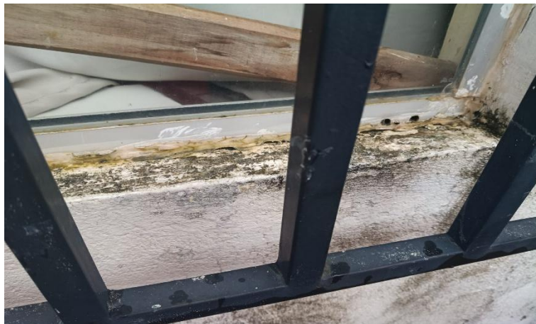
Figura 58 - Formação de lodo na janela do quarto.
