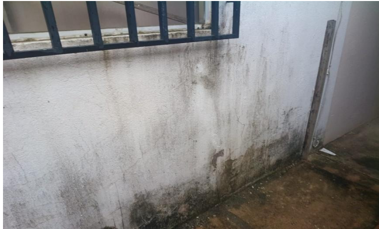
Figura 57 - Manchas devido a umidade na parede dos quartos.
