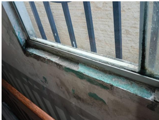
Figura 38 - Manchas e deslocamento de pintura devido a umidade na parede do quarto.
