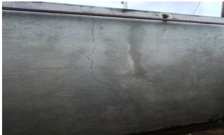
Figura 52 - Fissura no muro frontal.
