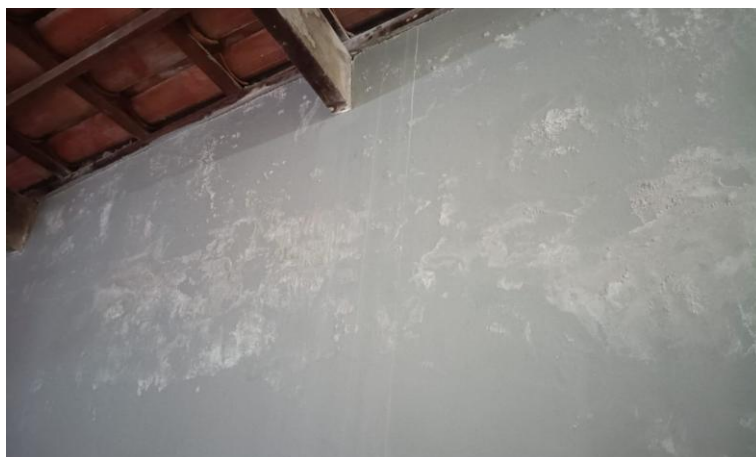
Figura 65 - Formação de bolhas na parede da varanda.
