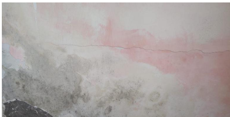
Figura 17 - Fissura na parede do dormitório 01.
