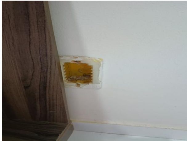
Figura 44 - Ausência de acabamento em tomada.
