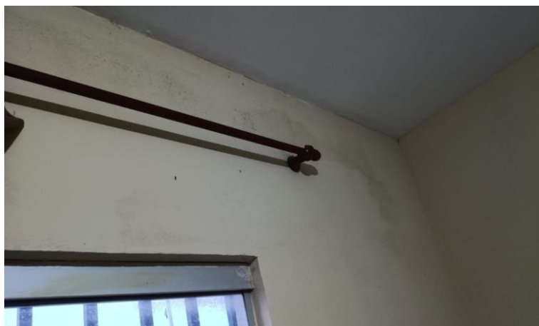
Figura 62 - Manchas na face externa da parede do quarto.
