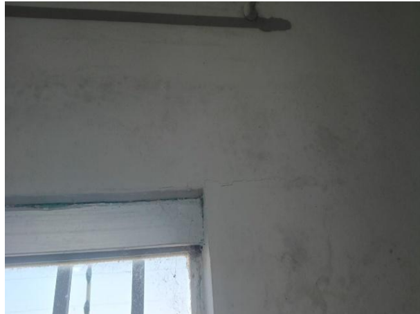
Figura 37 - Manchas decorrentes de umidade na parede do quarto.
