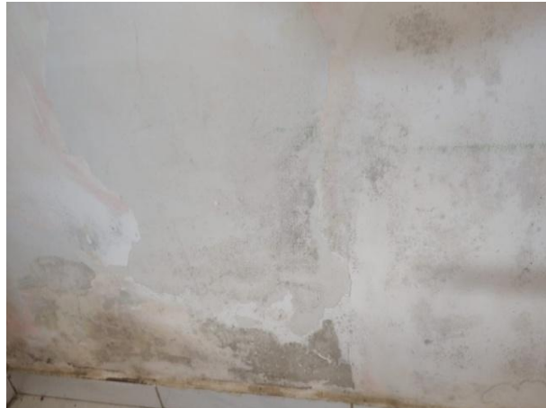
Figura 27 - Manchas decorrentes de umidade no dormitório 01.
