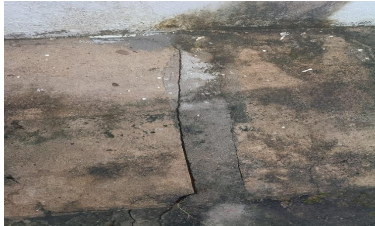
Figura 54 - Trinca no pavimento.
