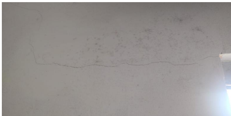
Figura 20- Fissura porta do dormitório 02.
