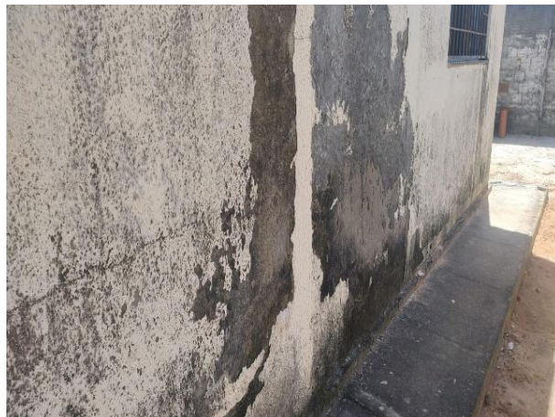
Figura 31 - Lodo e deslocamento da pintura na face externa da parede dos dormitórios
