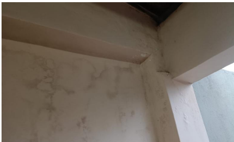
Figura 67 - Manchas devido a presença de umidade na parede da varanda.
