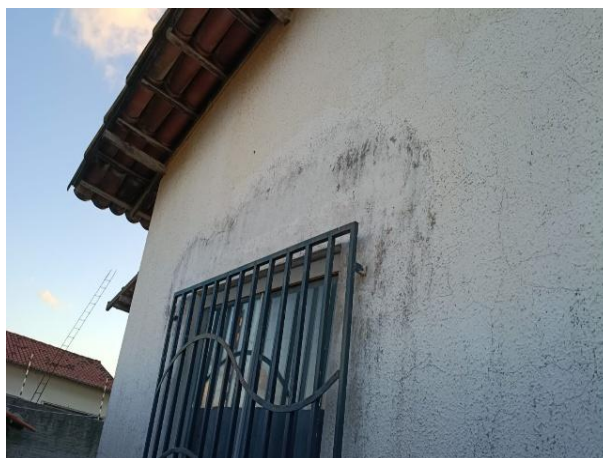
Figura 42 - Manchas devido a umidade na parede da suíte.
