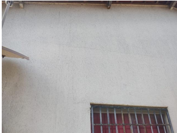
Figura 24 - Trinca na junção da laje com alvenaria.
