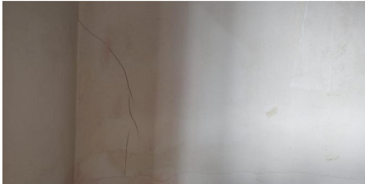
Figura 18 - Fissura na parede do dormitório 02.
