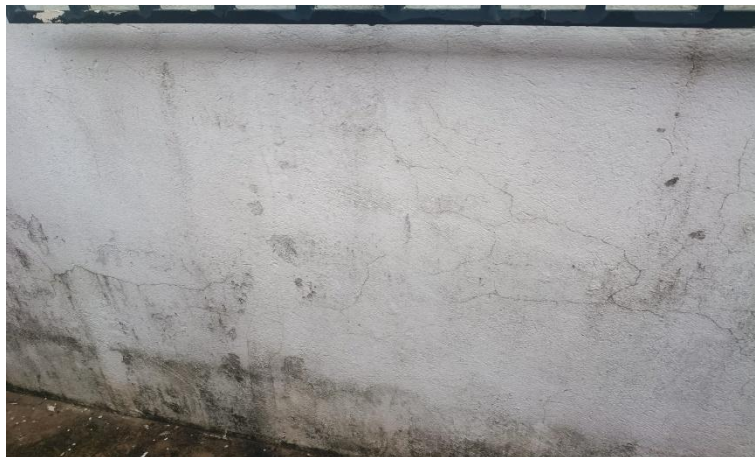
Figura 55 - Manchas e fissuras na face externa das paredes dos quartos.
