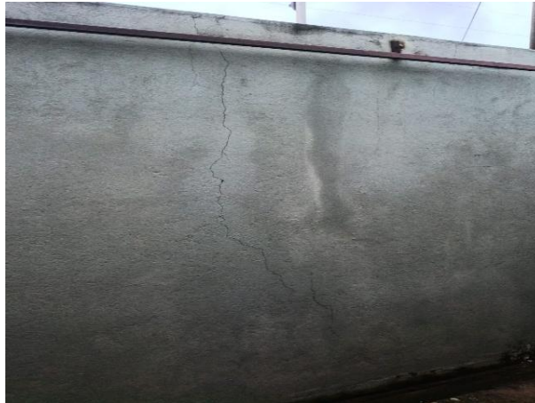
Figura 34 - Fissura no muro frontal.
