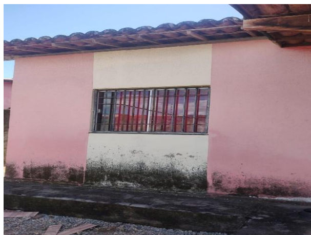
Figura 29 - Lodo formado na face externa da parede da sala
