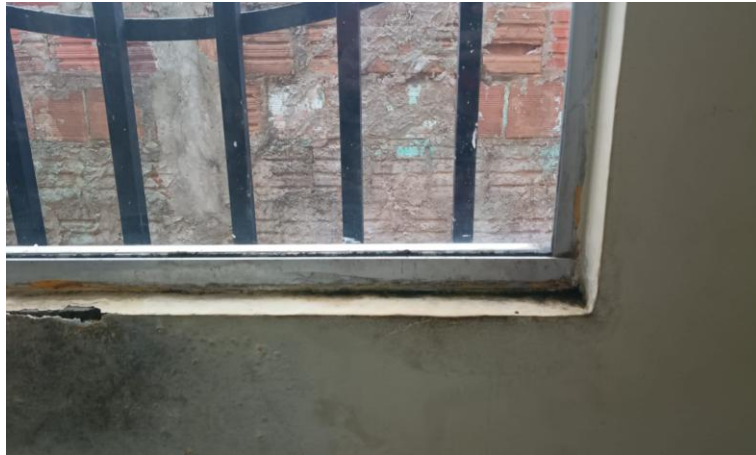
Figura 63 - Manchas decorrentes de umidade na janela do quarto.
