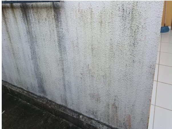
Figura 40 - Formação de lodo na parede na faxe externa da parede do quarto.
