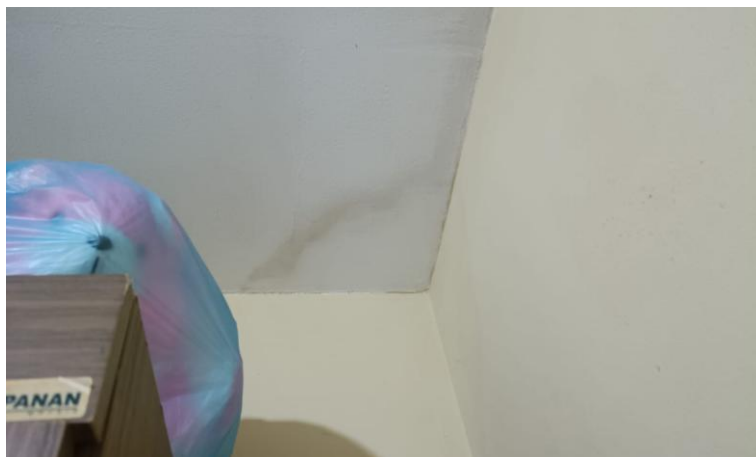
Figura 64 - Manchas no teto do quarto por infiltração.
