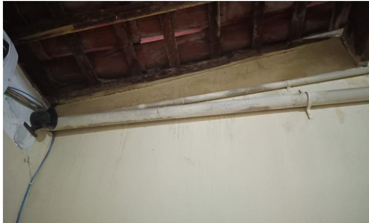
Figura 60 - Manchas na parede da cozinha devido a umidade.
