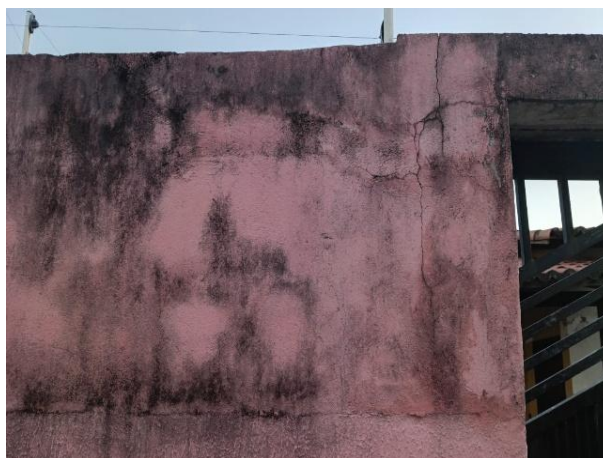
Figura 36 - Fissuras e lodo no face externa do muro frontal.
