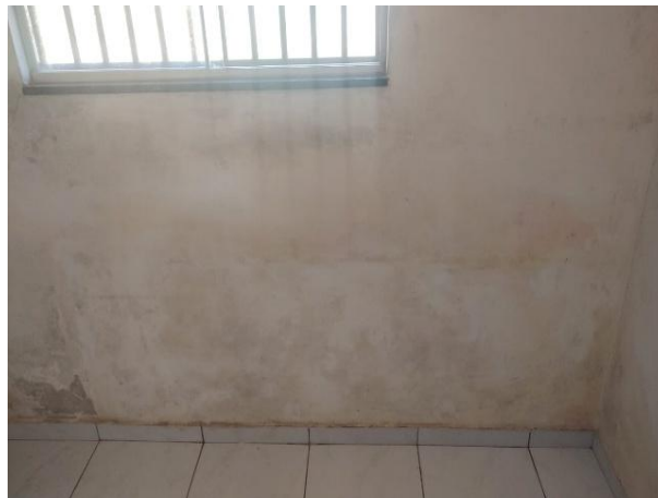
Figura 25 - Manchas devido a umidade da parede
