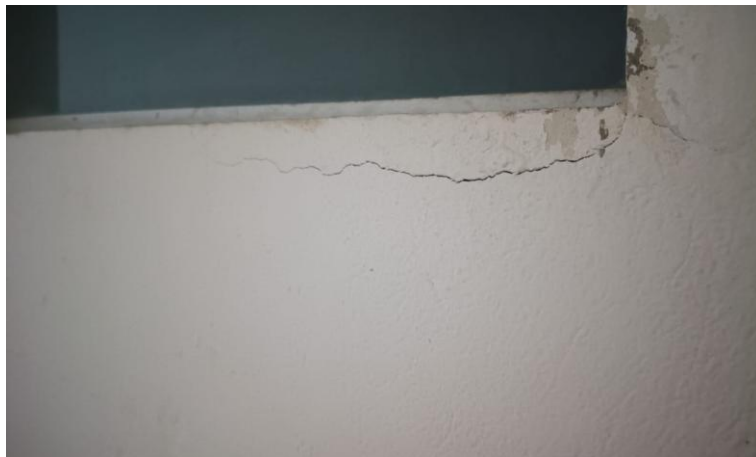
Figura 61 - Trinca na parede próximo a janela do banheiro.
