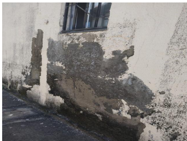
Figura 32 - Lodo e deslocamento da pintura na face externa da parede dos dormitórios.
