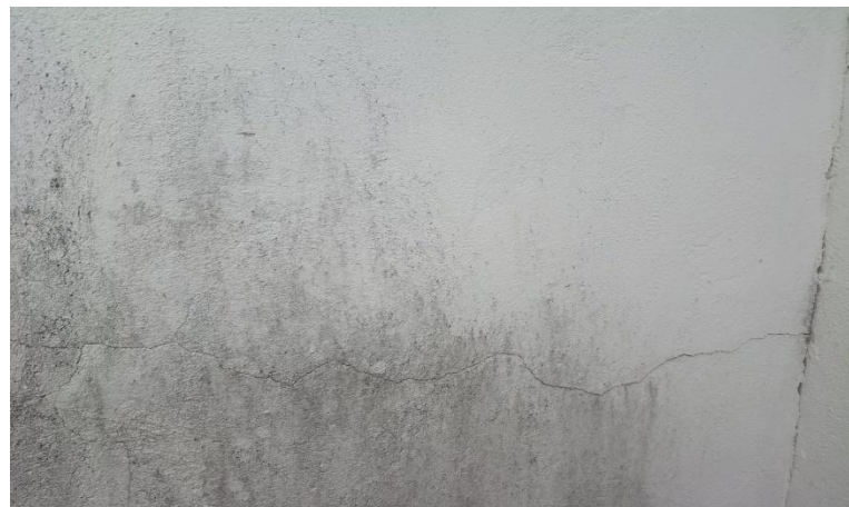
Figura 50 - Fissura na face da parede externa dos quartos.
