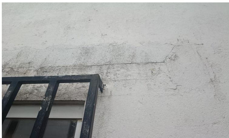
Figura 56 - Fissuras próximo a janela do quarto.
