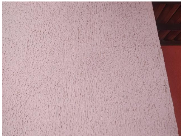
Figura 22 - Fissura porta da sala
