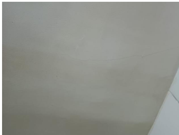
Figura 45 - Fissura na parede do quarto.
