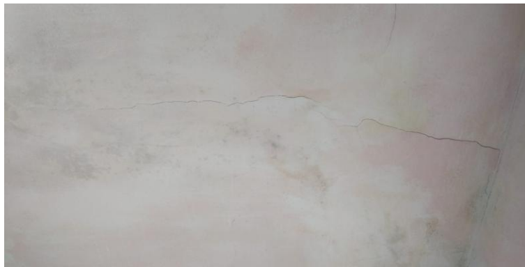
Figura 19 - Fissura na parede do dormitório 01.
