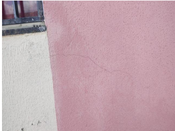
Figura 21 - Fissura na janela da sala
