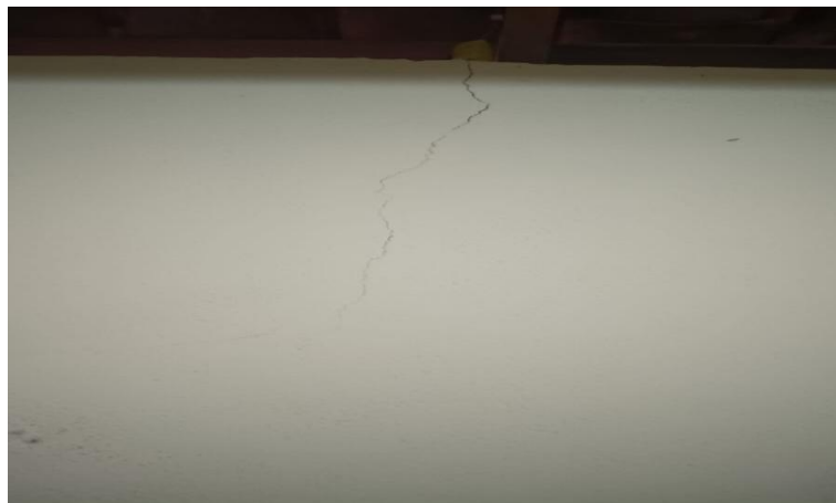
Figura 53 - Fissura na parede da cozinha.
