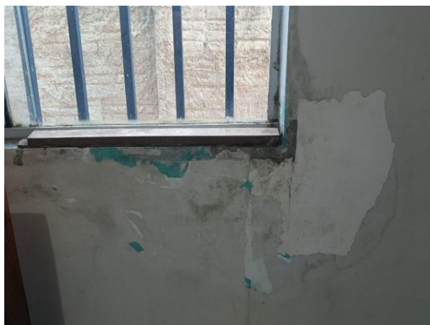
Figura 39 - Manchas e deslocamento de pintura devido a umidade na parede do quarto.
