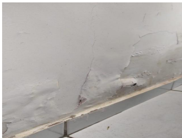
Figura 26 - Deslocamento de revestimento na sala
