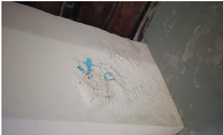
Figura 66 - Deslocamento de pintura na parede da varanda.
