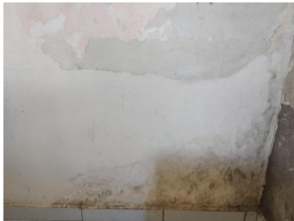
Figura 28 - Manchas decorrentes de umidade no dormitório 01.
