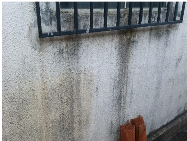
Figura 41 - Manchas e formação de lodo devido a umidade.
