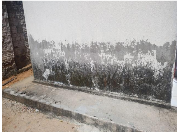
Figura 30 - Lodo formado na face externa da parede de fundos do dormitório 02.
