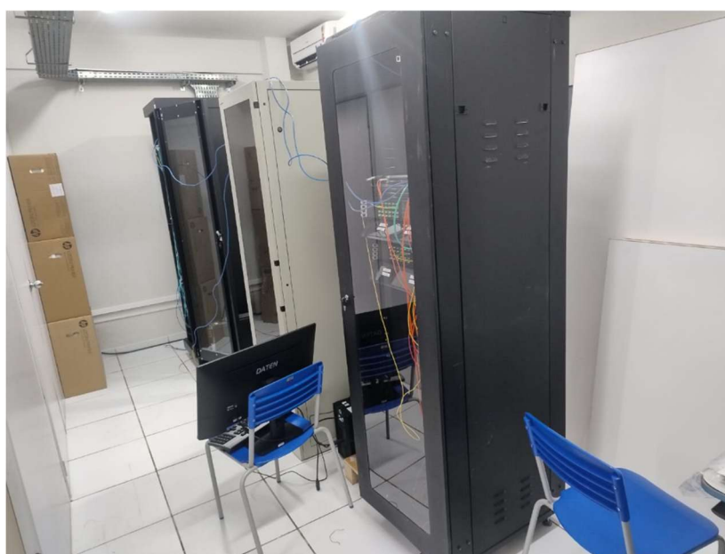
Figura 4 - O Datacenter do Campus
