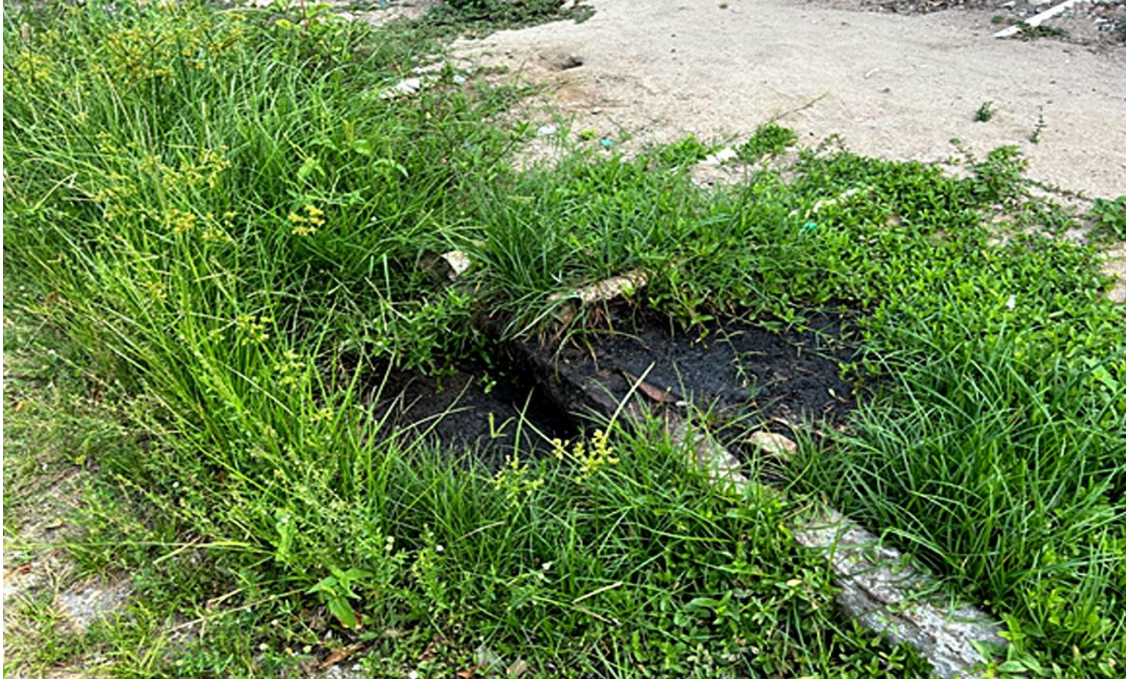
Figura 9 – Esgoto a céu aberto: Bairro Parque de Exposição
