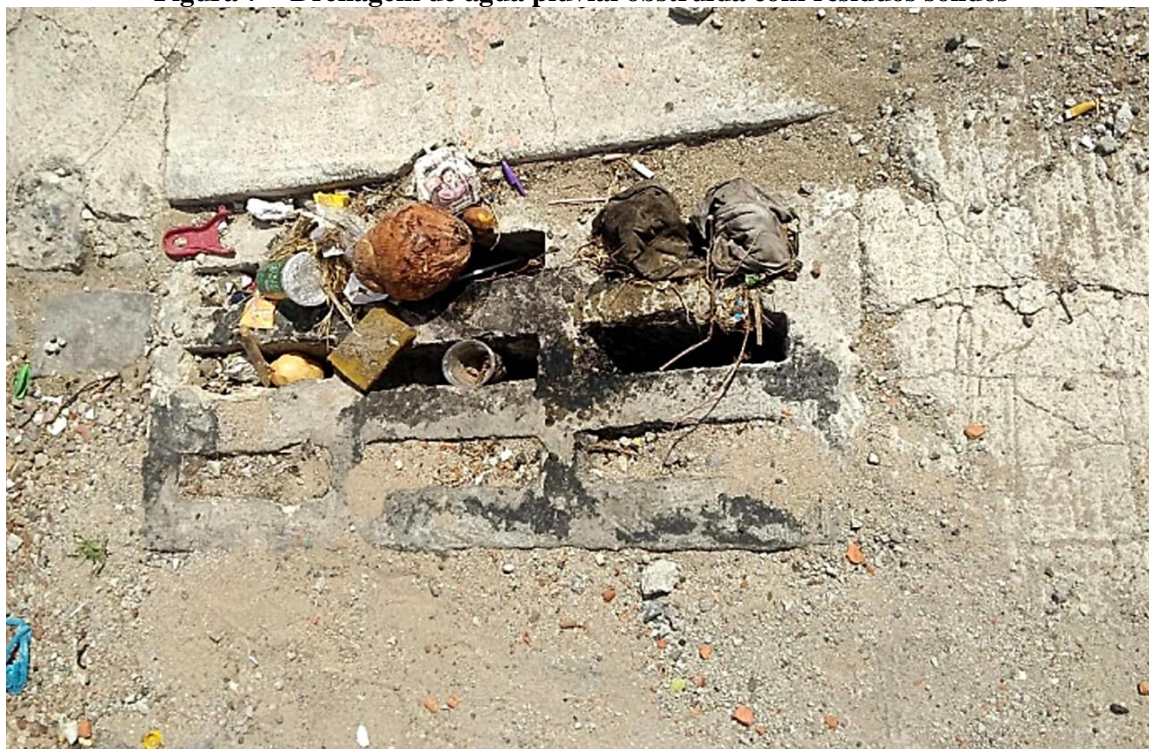
Figura 7 – Drenagem de água pluvial obstruída com resíduos sólidos
