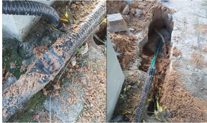
Figura 33 - Caixa de passagem dos cabos CA esmagados – campus de João Câmara
