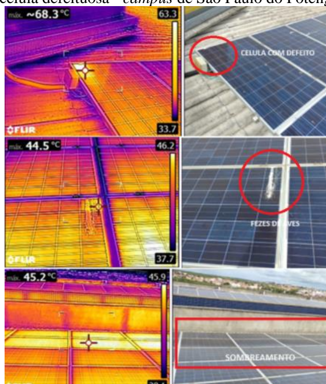
Figura 91 - Pontos quentes causado por sombreamento pelas laterais do prédio, por sujeira e célula defeituosa - campus de São Paulo do Potengi
