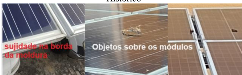
Figura 118 - Sujidade e objetos sobre os módulos fotovoltaicos – campus de Natal-Centro Histórico
