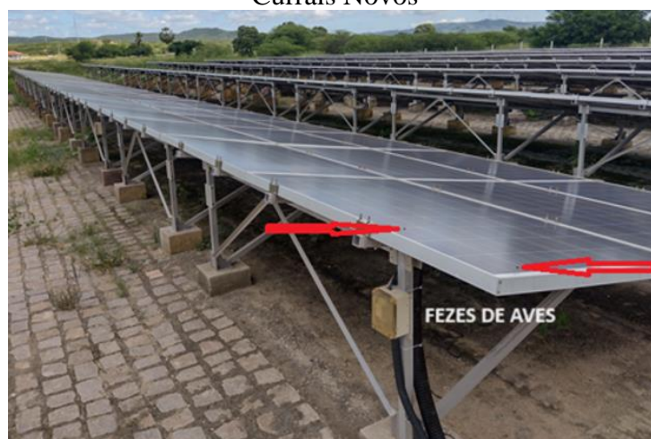
Figura 100 - Sistema fotovoltaico, limpo e com pouco excrementos de aves - campus de Currais Novos
