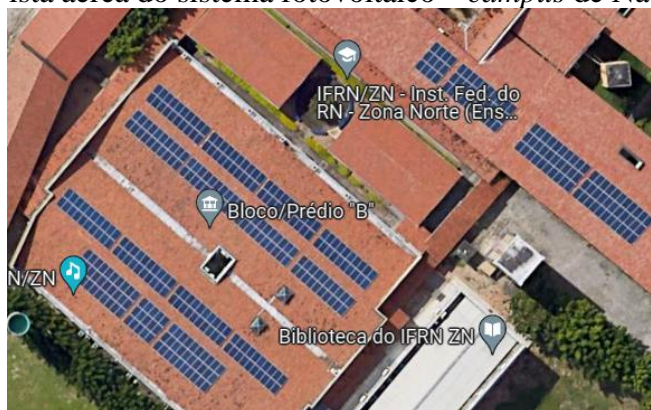
Figura 64 - Vista aérea do sistema fotovoltaico – campus de Natal Zona Norte
