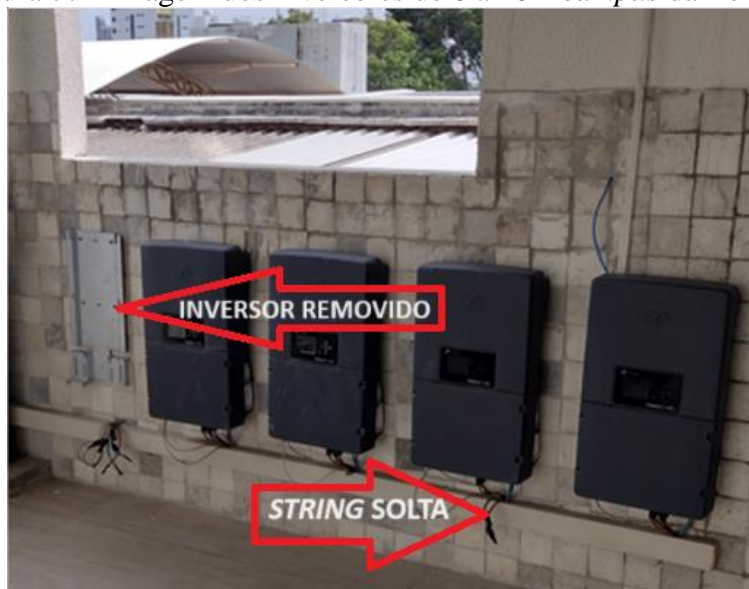
Figura 77 - Imagem dos inversores de 6 a 10 – campus da Reitoria
