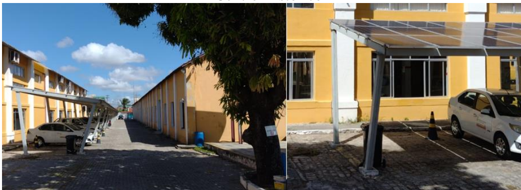
Figura 120 - Sombreamento por árvore sobre o sistema fotovoltaico – campus de Natal-Centro Histórico
