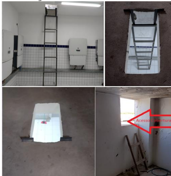
Figura 57 - Acesso aos arranjos do sistema fotovoltaico do campus de Santa Cruz
