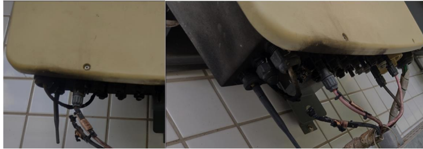
Figura 51 - Princípio de incêndio na entrada do Inversor ABB número 3
