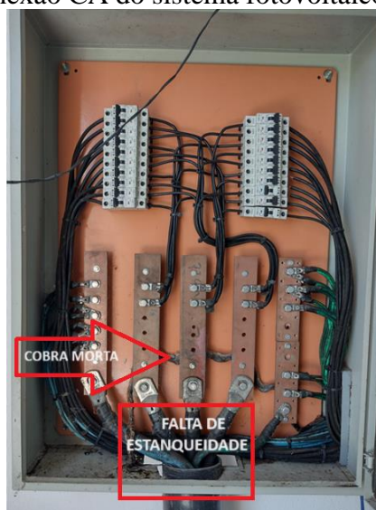
Figura 104 - Quadro de conexão CA do sistema fotovoltaico – campus de Curais Novos
