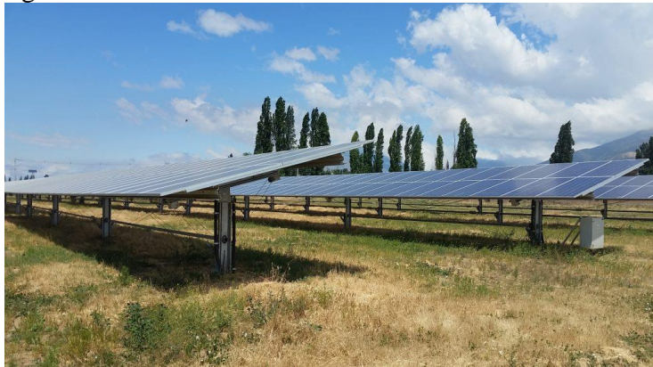
Figura 6 - Usina fotovoltaica da Tritec-Intervento no Chile
