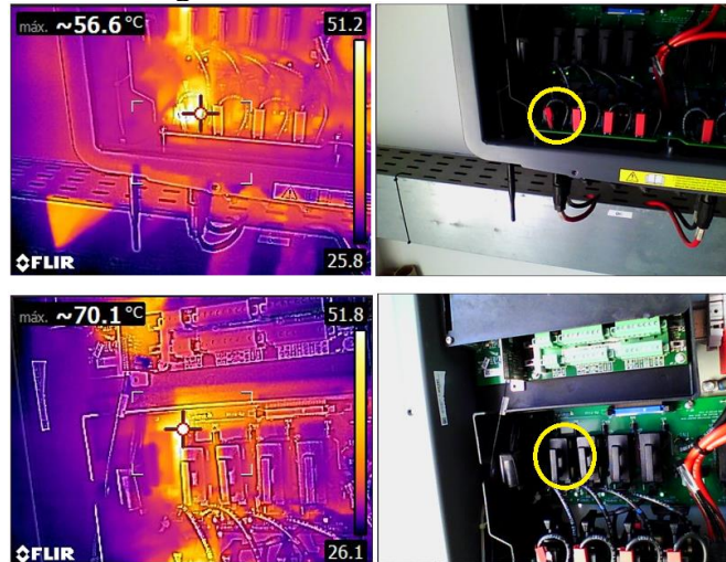
Figura 45 - Imagens térmicas na entrada CC dos inversores
