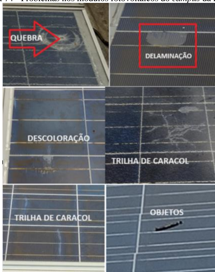
Figura 74 - Problemas nos módulos fotovoltaicos do campus da Reitoria
