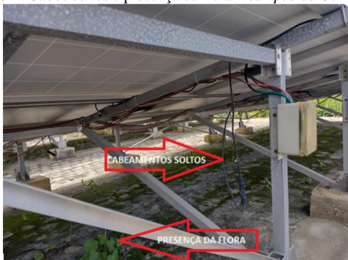
Figura 101 - Cabos soltos e presença da flora – campus de Currais Novos
