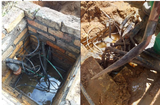
Figura 32 - Caixa de passagem dos cabos CA inundada – campus de João Câmara
