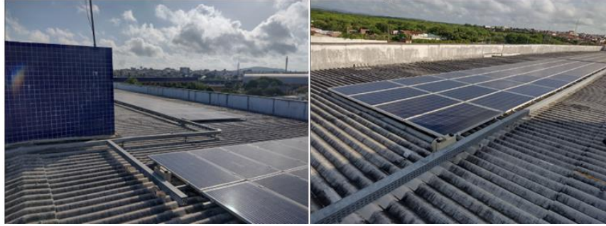
Figura 56 - Arranjos do sistema fotovoltaico do campus de Santa Cruz
