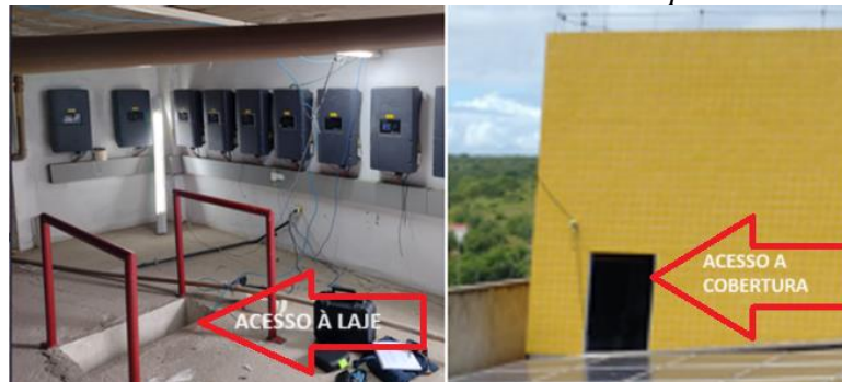
Figura 87 - Detalhes do acesso ao sistema fotovoltaico do campus de São Paulo do Potengi
