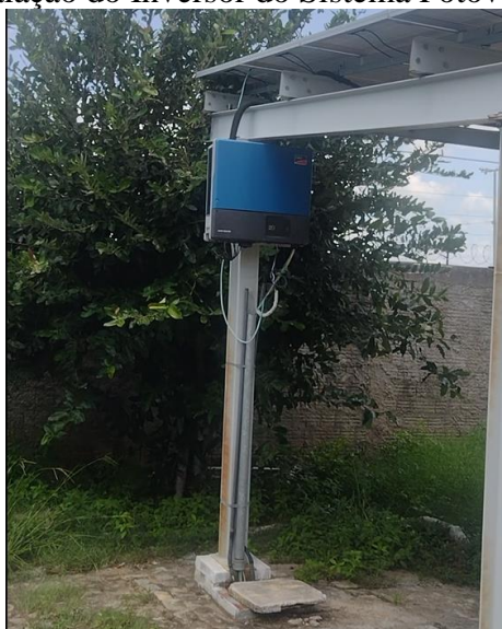
Figura 115 - Vista da Instalação do Inversor do Sistema Fotovoltaico do campus de Caicó
