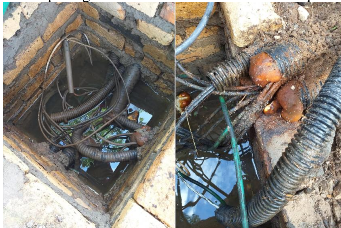
Figura 31 - Caixa de passagem dos cabos CA inundada – campus de João Câmara
