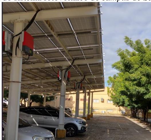
Figura 109 - Vista do sistema fotovoltaico do campus de São Paulo do Potengi
