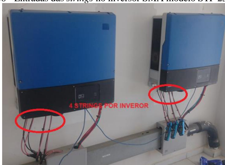
Figura 106 - Entradas das strings no inversor SMA modelo STP 25000TL-30
