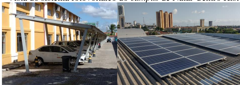
Figura 116 - Vista do sistema fotovoltaico do campus de Natal-Centro Histórico
