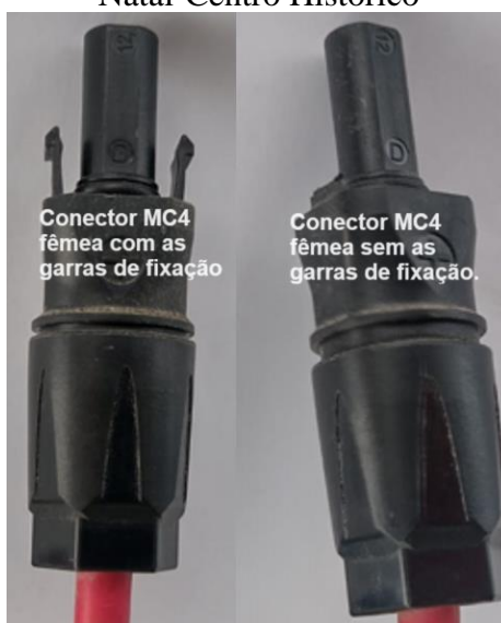
Figura 121 - Conector MC4 sem as garras de fixação causado por ressecamento – campus de Natal-Centro Histórico
