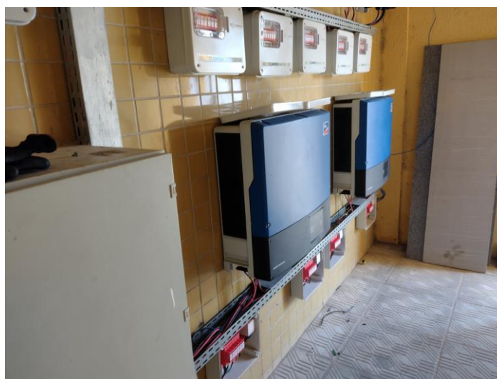
Figura 113 - Vista dos inversores e quadro de conexão CA do sistema fotovoltaico do campus de Pau dos Ferros
