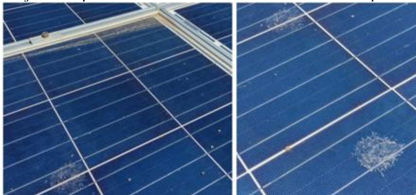
Figura 59 - Sujidade depositado sobre os módulos fotovoltaicos - campus de Santa Cruz
