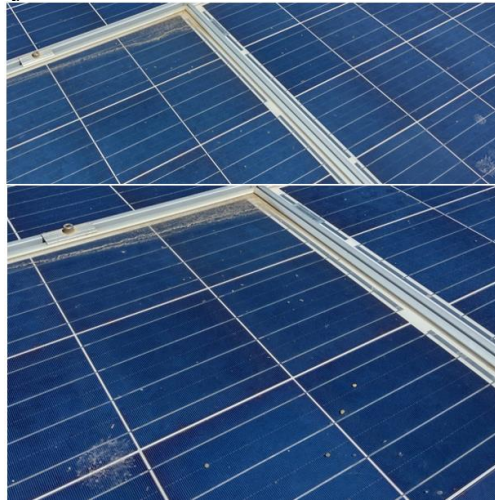
Figura 43 - Sujidade nos módulos fotovoltaicos - campus de Lajes
