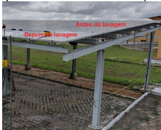
Figura 35 - Limpeza do sistema fotovoltaico – campus de João Câmara
