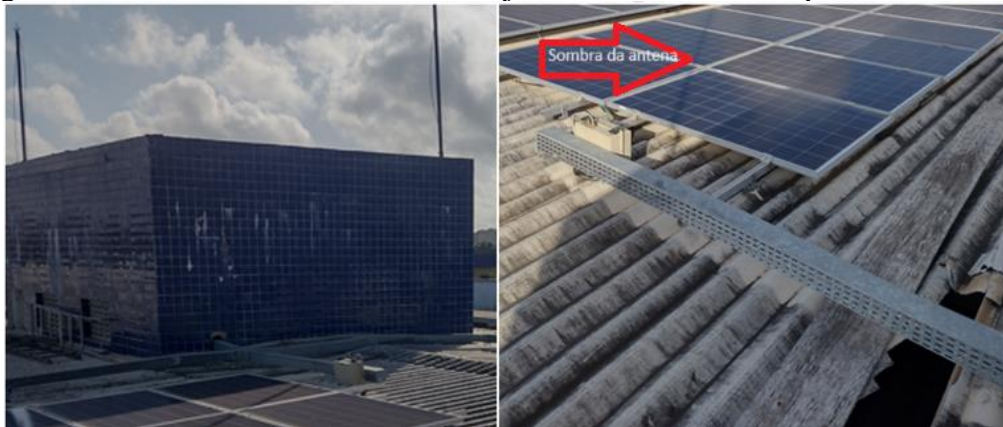
Figura 60 - Sombreamento sobre os arranjos fotovoltaico do campus de Santa Cruz
