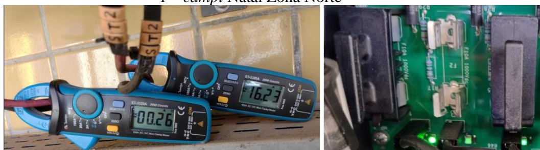
Figura 66 - Corrente operacional da string 1 com zero ampere e base sem fusível do inversor 1 - campi Natal Zona Norte
