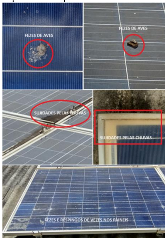
Figura 82 - Sujeiras depositadas nos painéis fotovoltaicos do campus de Ceará Mirim
