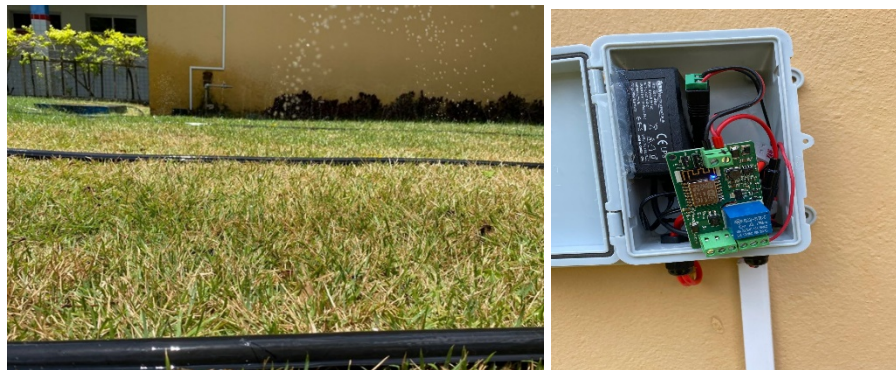
Figura 2 - Setor irrigado e gabinete mostrando o microcontrolador instalado.
