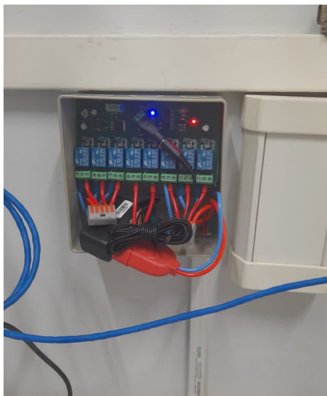
Figura 4 - Módulo dos relés do Auditório Principal, gabinete aberto.
