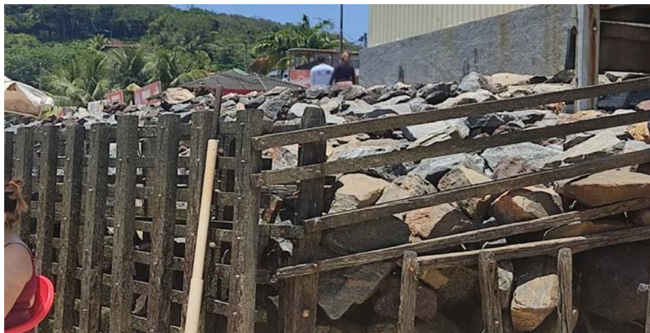
Figura 15 - Ações antropogênicas para contenção da erosão costeira em barracas da praia do Centro, Pipa/RN
