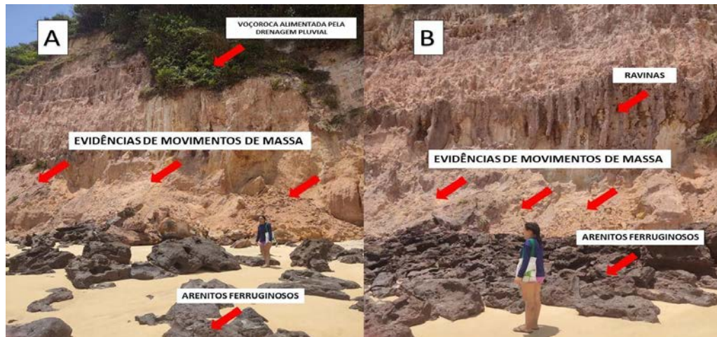
Figura 7 - Evidências de movimentos de massa no trecho da praia do Madeiro e Baía dos Golfinhos, Pipa/RN
