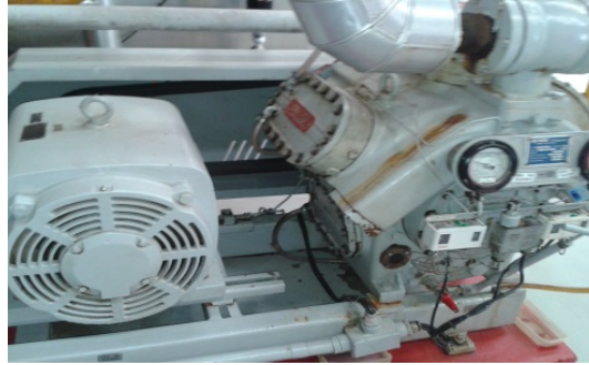
Figura 2 – Motor do compressor sabroe
