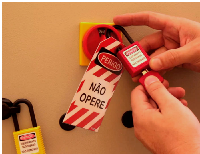
Figura 35 – Dispositivos de bloqueio e etiquetagem.
