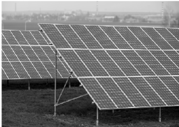
Figura 6 – Usina de eletricidade fotovoltaica.
