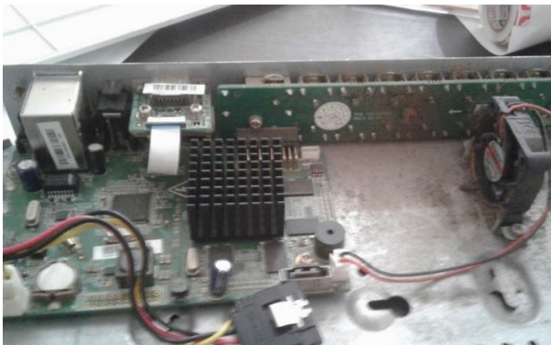
Figura 02- DVR com acúmulo de poeira
