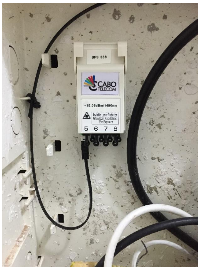
Figura 32 – TAP óptico instalado nas prumadas de edifícios e condomínios
