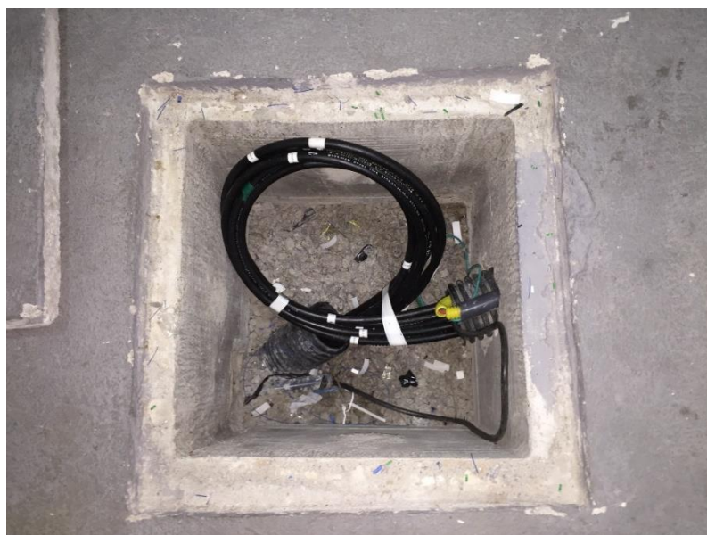
Figura 17 – Caixa de passagem anterior ao gabinete
