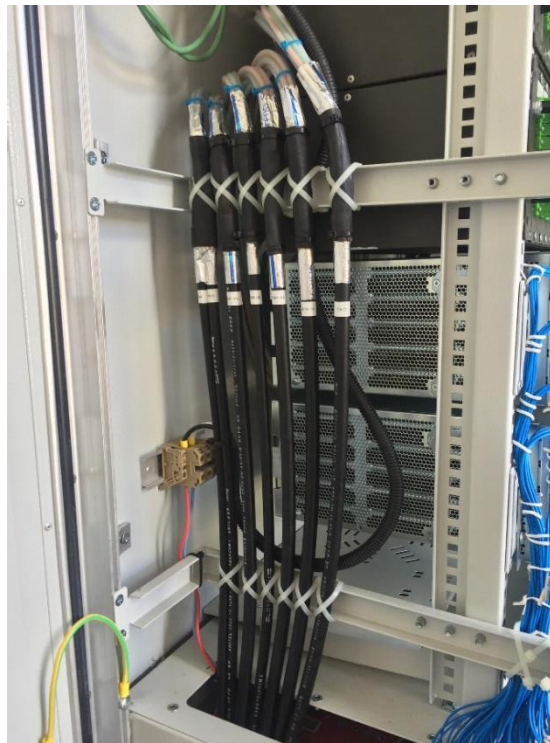
Figura 18 – Acomodação e identificação dos cabos ópticos no gabinete
