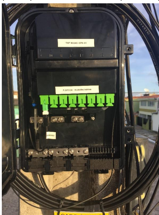
Figura 33 – Cabo tipo drop 01FO conectado a primeira porta do TAP óptico
