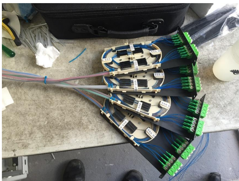
Figura 22 – Fibras do cabo óptico 64FO já acomodadas nos slots DIO
