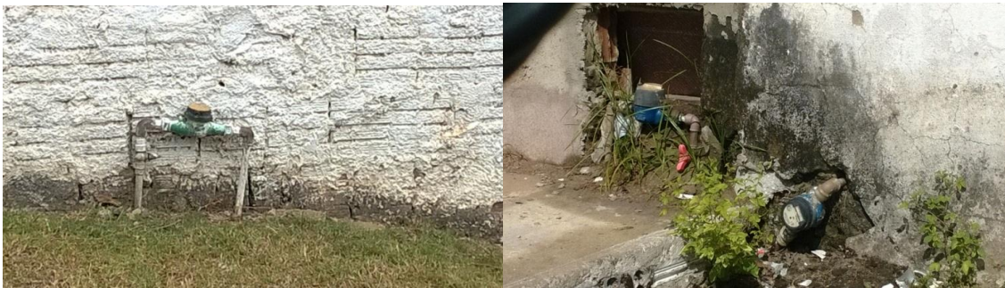
Figura 2: Situação precária dos hidrômetros sem proteção
