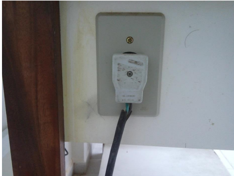
Figura 3 - Cabo sem revestimento.
