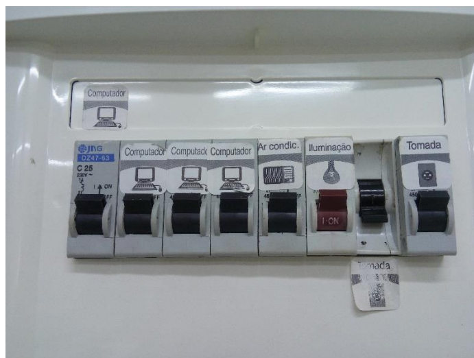
Figura 4 - Quadro de disjuntores.
