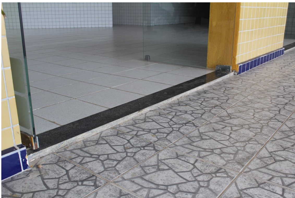
FIGURA 11 - Portas da entrada principal do prédio do Campus Parnamirim – Desnível na soleira
