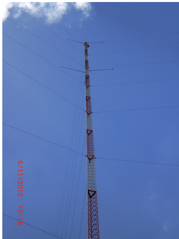
Figura 25 - Torre de medição. Fonte: Gerente Executivo dos Parques Eólicos de Alegria I e II.
