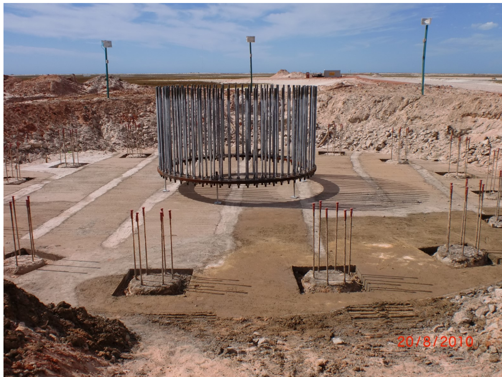
Figura 38– Concretagem de regulação e armação. Fonte: Gerente Executivo dos Parques Eólicos de Alegria I e II.
