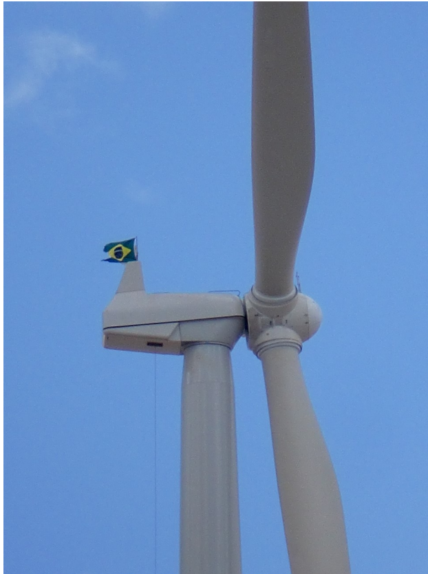
Figura 52– Vista lateral do aerogerador. Fonte: Gerente Executivo dos Parques Eólicos de Alegria I e II.
