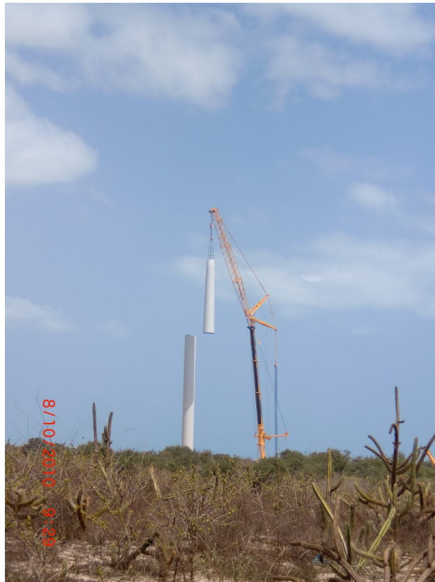
Figura 48– Montagem do terceiro estágio da torre. Fonte: Gerente Executivo dos Parques Eólicos de Alegria I e II.
