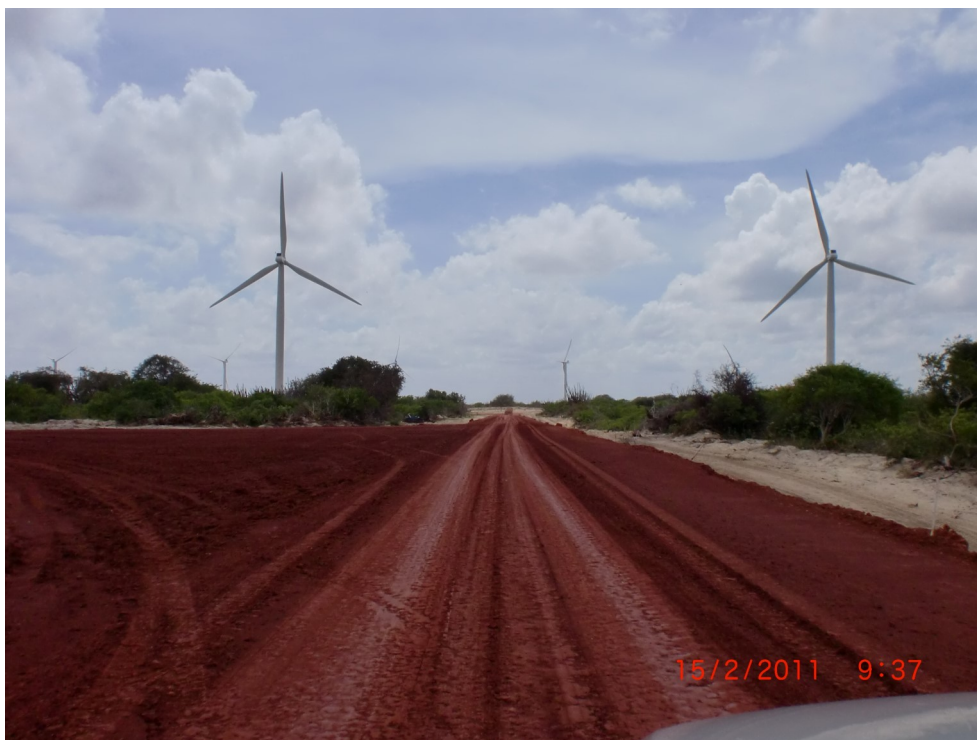
Figura 27- Construção de Via de Acesso no Parque Eólico de Alegria I. Fonte: Gerente Executivo dos Parques Eólicos de Alegria I e II.
