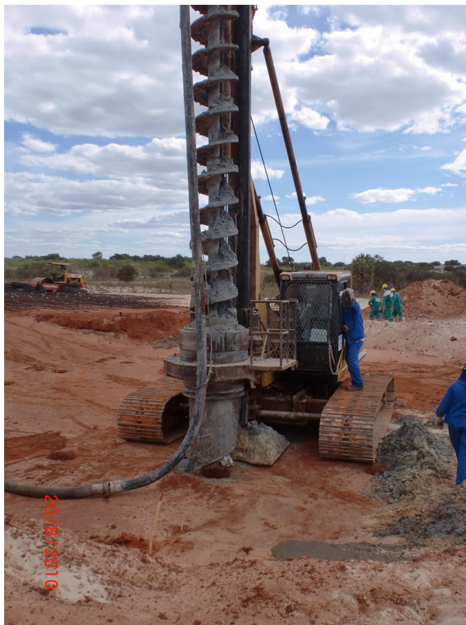
Figura 37– Execução e arrastamento das estacas da fundação. Fonte: Gerente Executivo dos Parques Eólicos de Alegria I e II.
