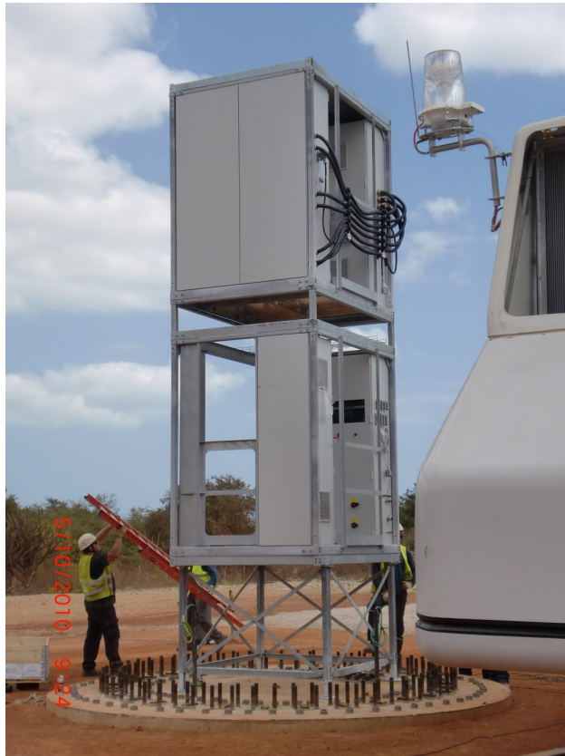
Figura 44– Quadro de circuitos da base do aerogerador. Fonte: Gerente Executivo dos Parques Eólicos de Alegria I e II.
