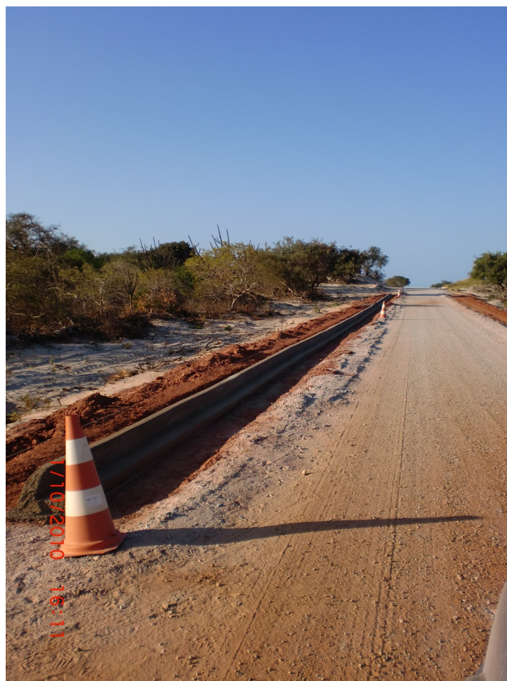
Figura 28- Construção de meio fio. Fonte: Gerente Executivo dos Parques Eólicos de Alegria I e II.
