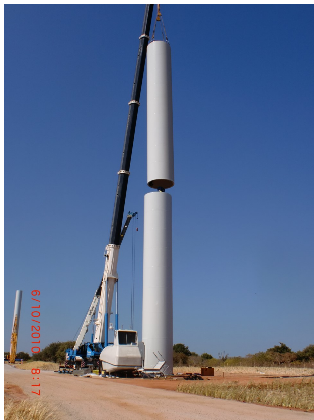
Figura 47– Montagem do segundo estágio da torre. Fonte: Gerente Executivo dos Parques Eólicos de Alegria I e II.
