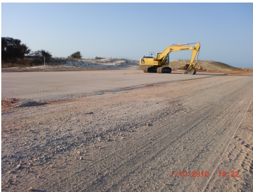
Figura 26 - Construção de Via de Acesso. Fonte: Gerente Executivo dos Parques Eólicos de Alegria I e II.
