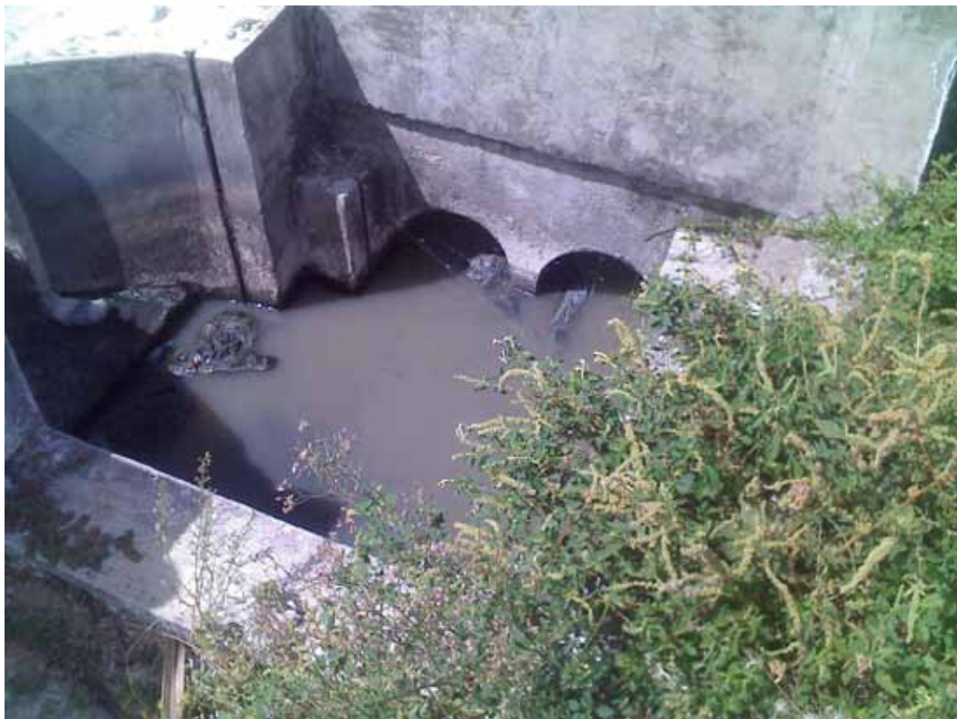
Figura 03-Condições da estação de tratamento no Conjunto Amarante.
