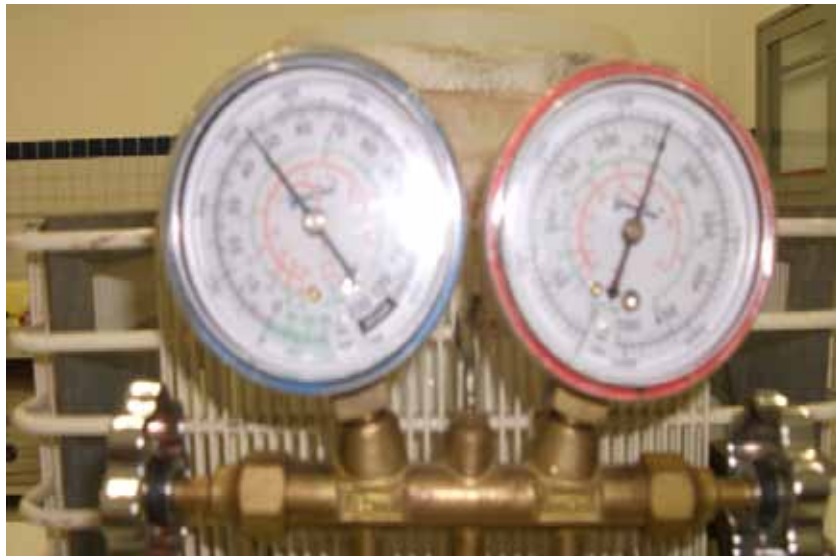
Figura 2 – Conjunto de manômetros instalado no refrigerador.
