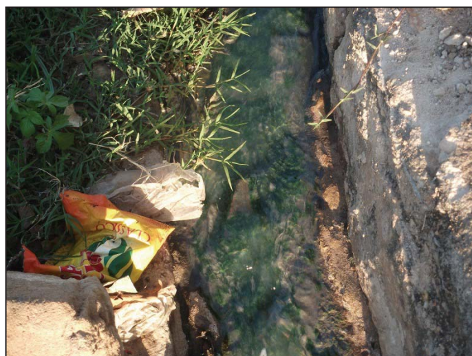
Figura 2: Acúmulo de lodo nas canaletas (sarjetas) nas bordas das calçadas das residências
