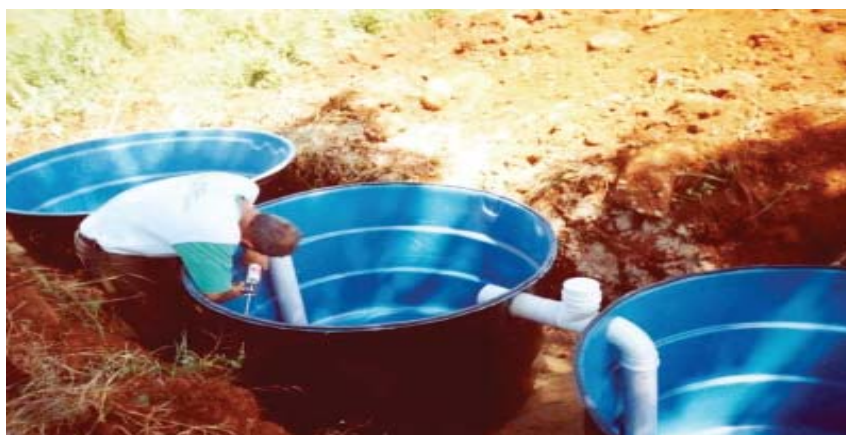
Figura 03- Tanque séptico feito com caixa d' água
