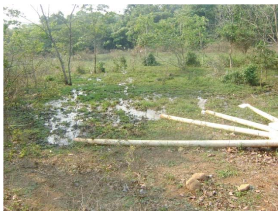
Figura 10- Disposição no Solo da ETE Pernada, Paraíso do Tocantins-TO.
