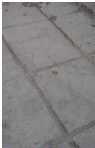
Figura 5. Foto do piso depois de assentado e curado (28 dias), não contendo trincas nem sinais de retração.
