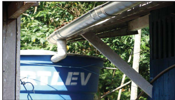
Figura 2: Reservatório e calha. FONTE: CRUZ, 2010
