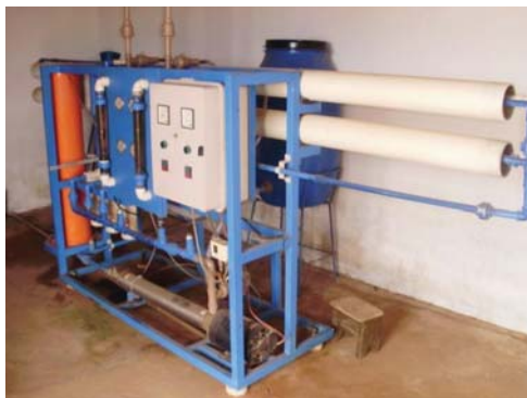
Figura 1. Equipamento de Dessalinização (FONTE: Arquivo do autor)
