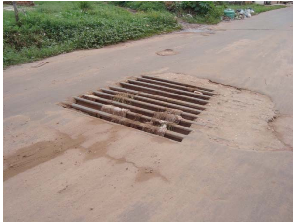
Figura 3- Grelha em via principal do bairro.
