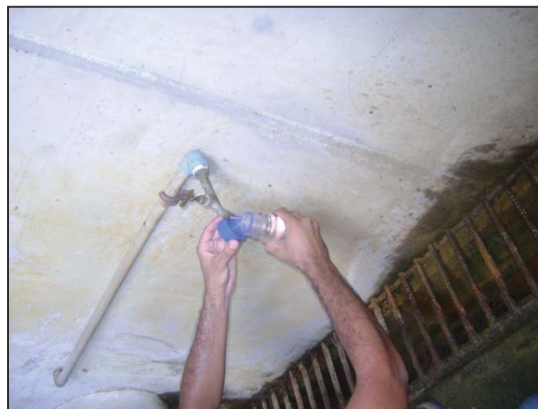
Figura 3 – Saída de água tratada do reservatório da estação de tratamento.
