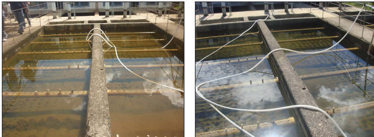
Figura 5 – Decantadores da ETA. Muito lodo nas chincanas, o que indicam que provavelmente não fazem a limpeza periódica das mesmas.
