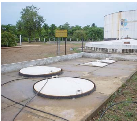
Figura 2 - Vista Geral da ETE Brejo Comprido.
