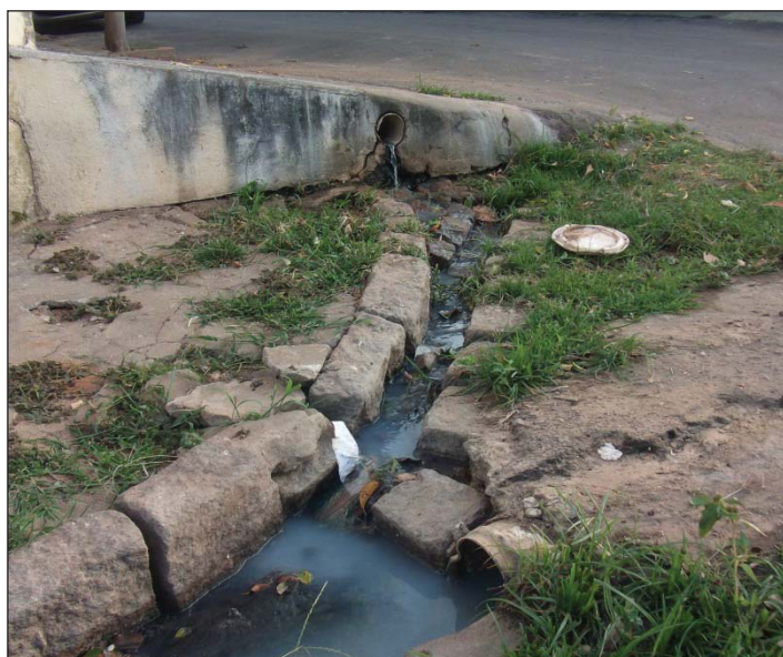
Figura 3: Disposição de efluente doméstico à céu aberto
