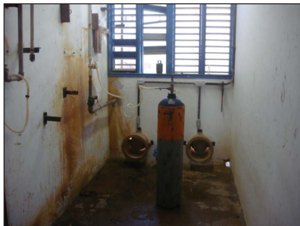
Figura 6 – Sala utilizada para o armazenamento do cilindro contendo cloro gasoso, detalhe nas péssimas condições de infraestrutura.
