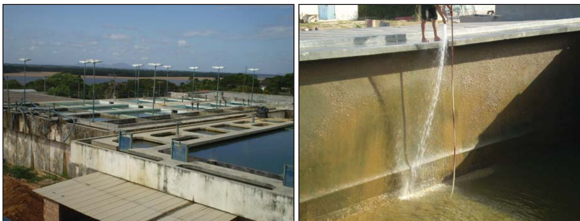
Figura 2a – ETA de Boa Vista/RR e 2b - Lavagem de tanque de decantação.
