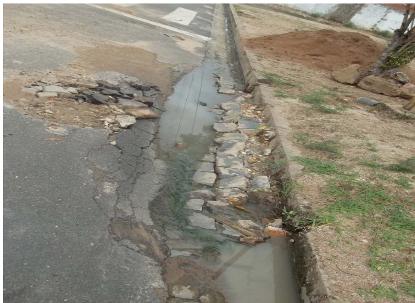
Figura 2: buracos na sarjeta devido falta de manutenção e velocidade do escoamento da água.
