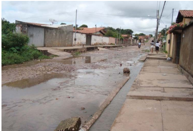
Figura 1- Empoçamento em rua com sarjetas obstruídas por sedimentos.
