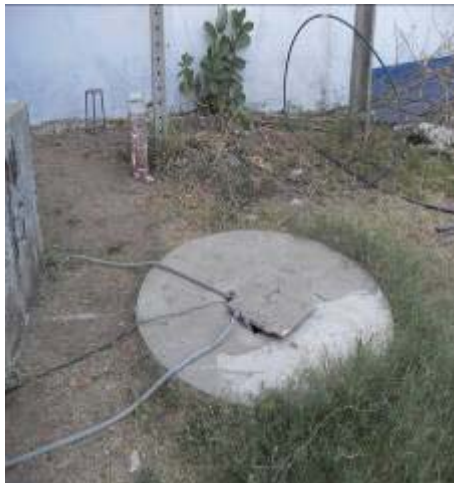
Figura 02- Tanque reservatório do esgoto proveniente de dois banheiros do IFCE-LN.
