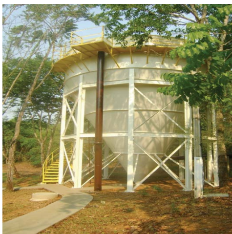
Figura 07 - Floccodecantador da ETE Pernada, Paraíso do Tocantins-TO.
