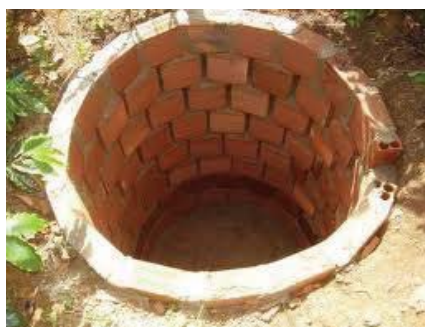
Figura 01- Concepção mais difundida no interior do Estado como sendo a “fossa séptica” ou Decanto Digestor.
