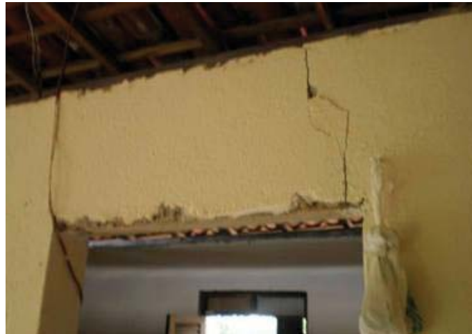
Foto 1 - Moradia com presença de trincas nas paredes
