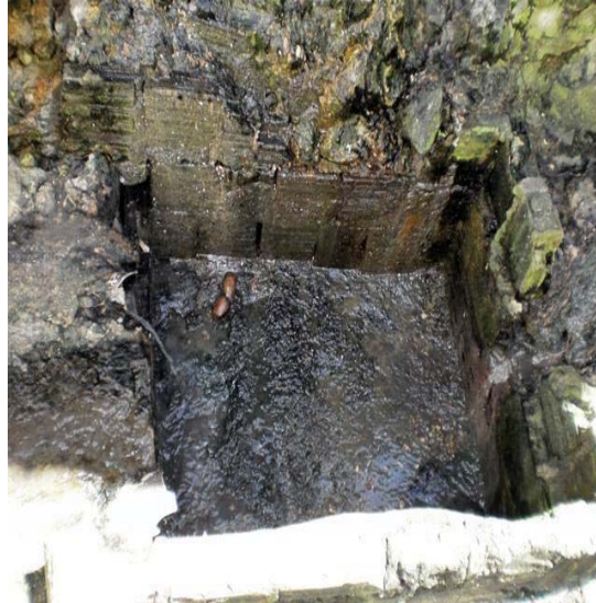
Foto 4 - Lançamento de águas servidas a céu aberto
