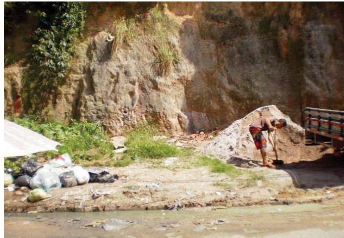
Foto 2 - Evidências de ocupação e utilização irregular na base da barreira
