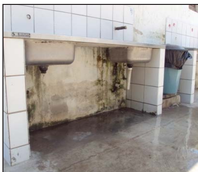
Figura 2 – Torneiras quebradas e vazamentos de água.
