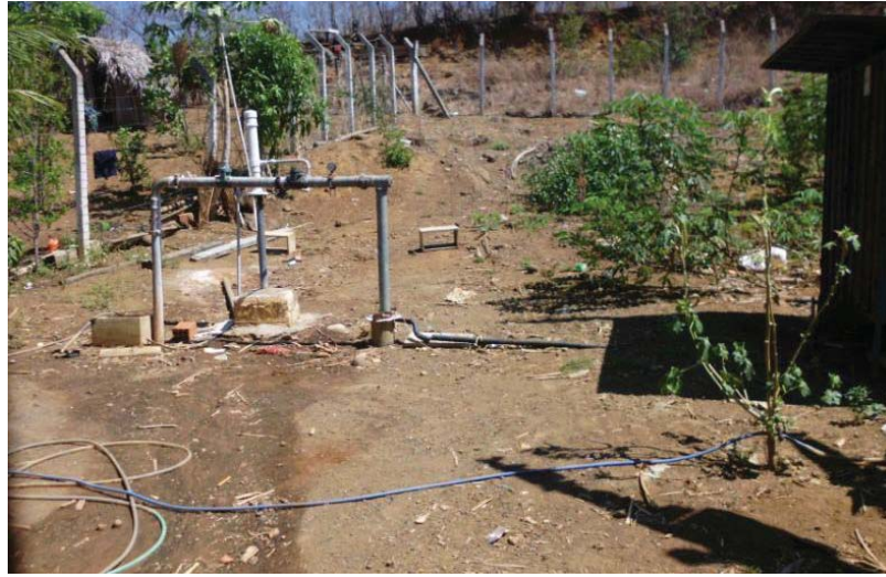
Figura 4: Poço da AGESPISA, localizado na Rua João Ferry, Zona Urbana de Miguel Leão – PI.
