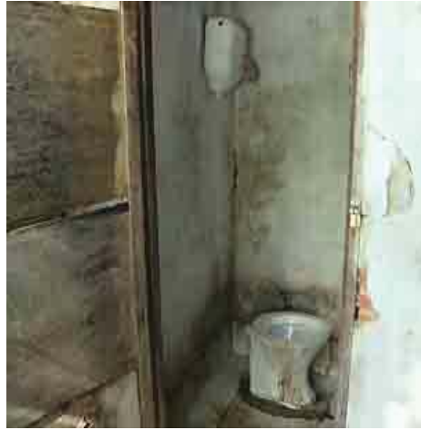
Figura 1- Banheiro de terminal de ônibus em Teresina-PI
