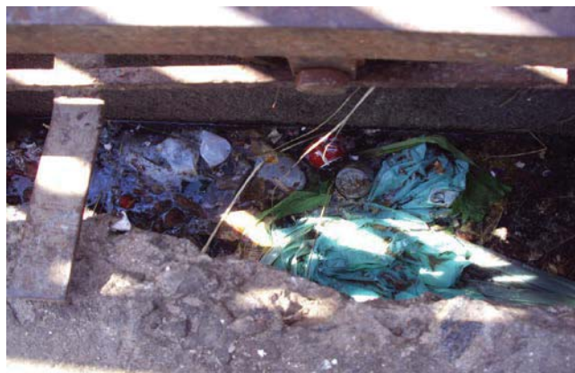
Figura 4 – Canaletas repletas de lixo
