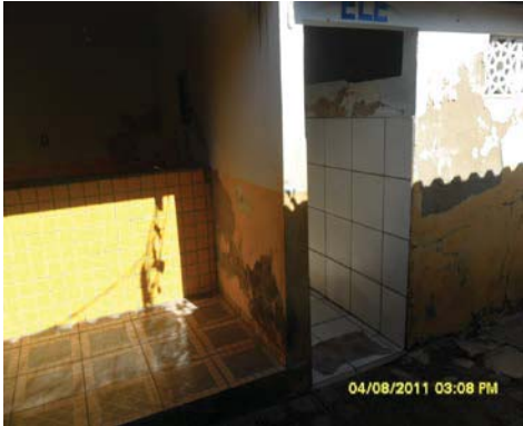
Figura 4: Área reservada para a manipulação dos alimentos próximo dos banheiros. Piso de difícil higienização e paredes danificadas.
