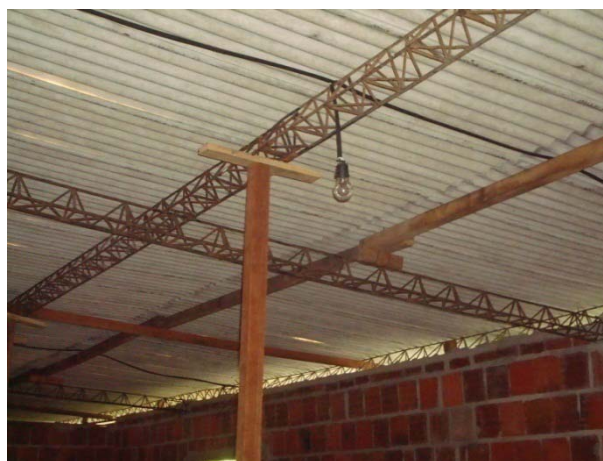
Figura 8 – Telhado de brasilite e iluminação artificial com lâmpada incandescente
