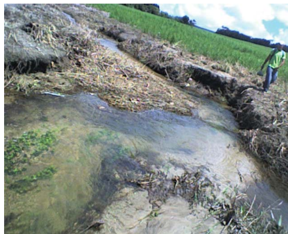
Figura 5. Assoreamento decorrente da erosão. Foto: Evanderson Conceição Lopes (Março/2008).
