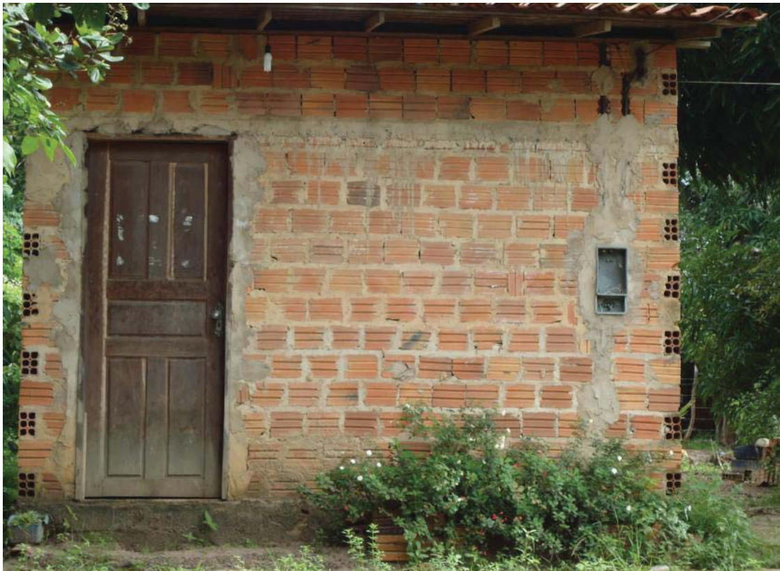
Figura 2- Casa mal acabada
