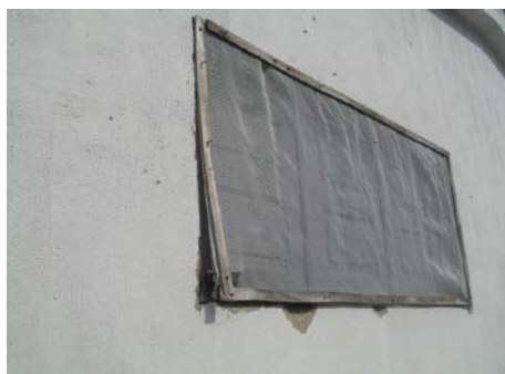
Figura 6: Tela de proteção em mau estado.
