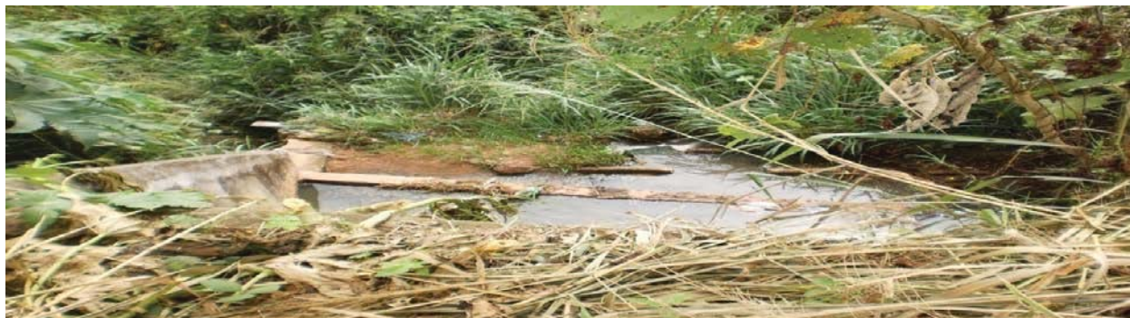
Figura 2. Efluentes domésticos lançados diretamente na lagoa via tubulação de esgoto.
