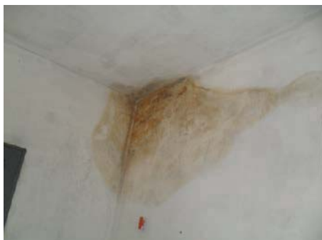
Figura 5: Infiltrações nas paredes
