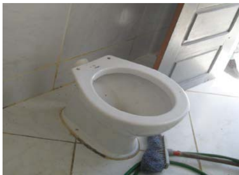
Figura 7: Instalação sanitária em mau estado de conservação.
