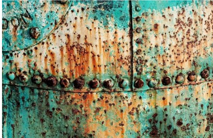
Figura 11: Ação corrosiva da água do mar em boia marítima.
