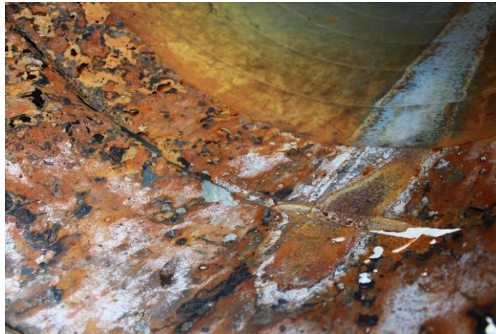
Figura 4: Corrosão galvânica/eletroquímica offshore.
