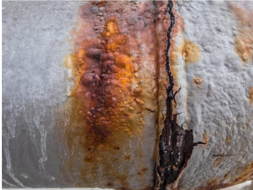
Figura 6: Corrosão sob tensão.
