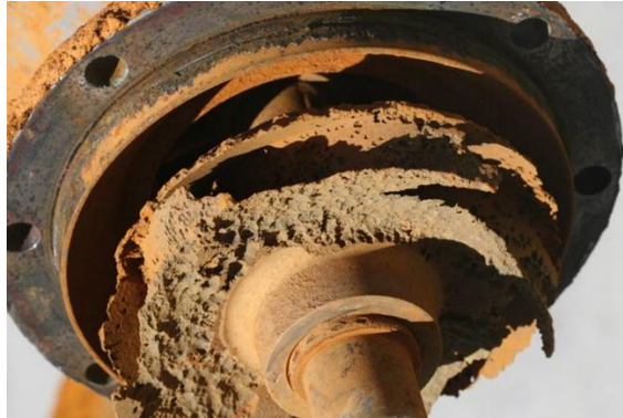
Figura 5 - Corrosão erosão em maquinário de bombeamento.
