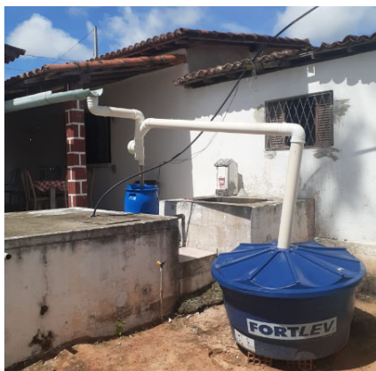
Figura 12 – Sistema piloto executado
