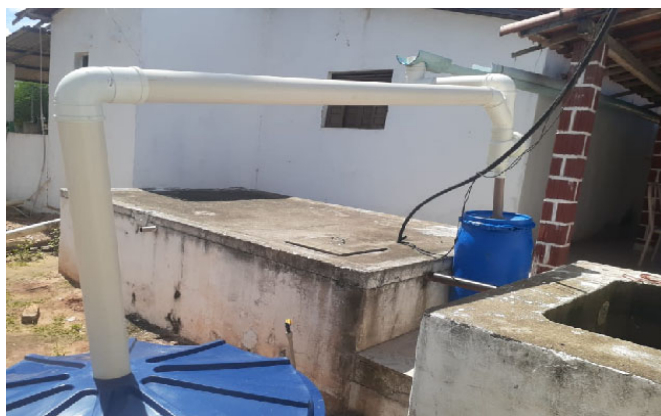
Figura 13 – Sistema piloto executado
