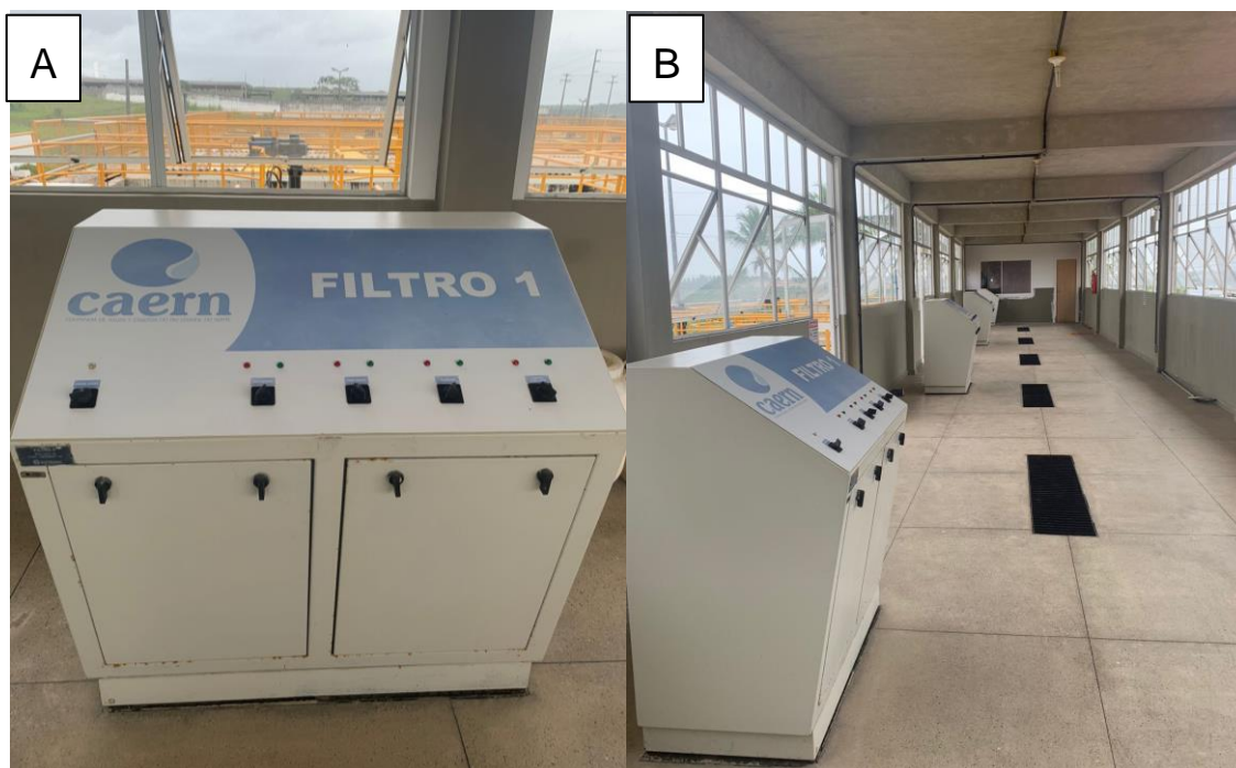
Figura 13 – A) Quadro de comando do Filtro 1; e B) Sala de Comando dos Filtros.
