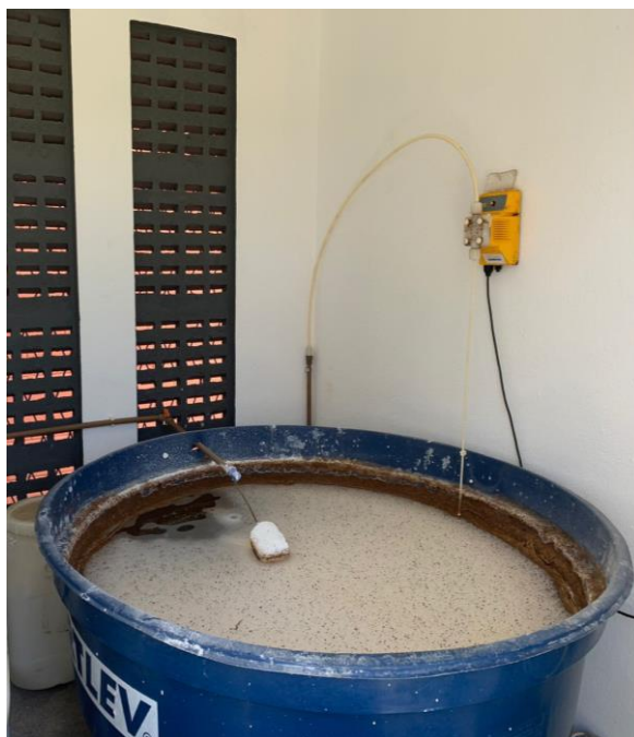
Figura 26 - Sistema de dosagem de Dicloro do R8.
