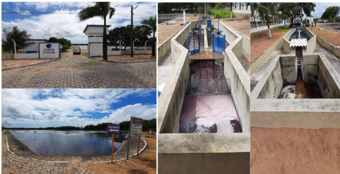
Figura 31: Estação de Tratamento de Esgoto do DIN.
