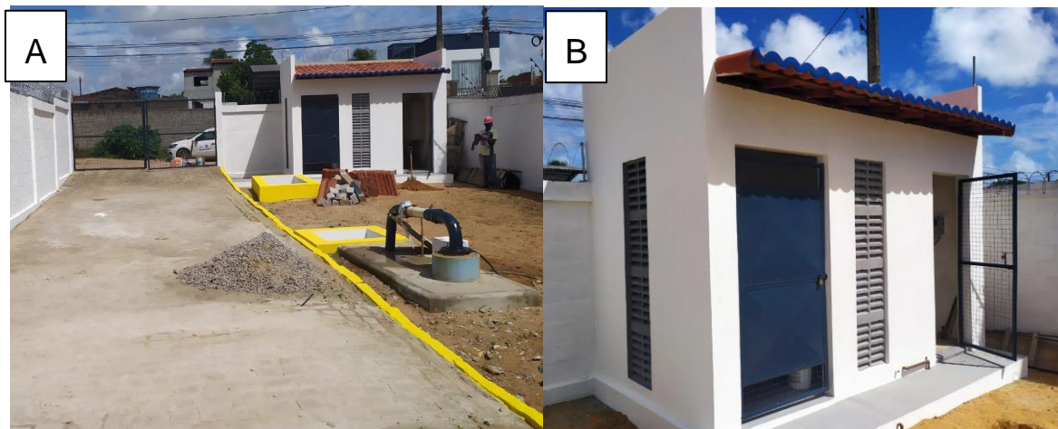
Figura 24 – A) Poço padrão CAERN; e B) Casa de química.
