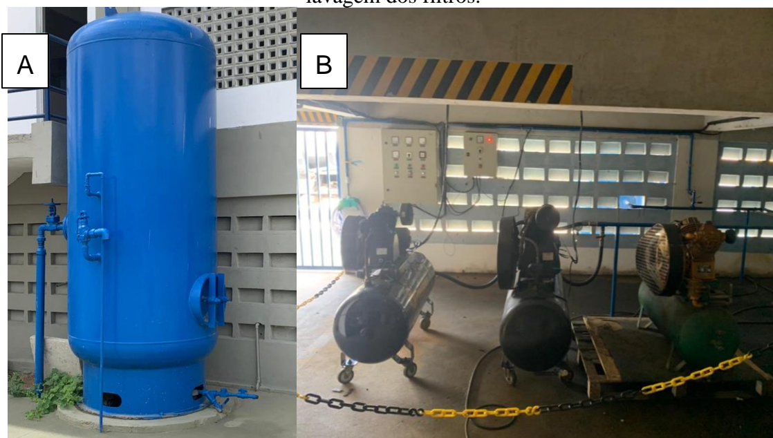
Figura 14 – A) Cilindro de ar comprimido; e B) Compressores de ar comprimido usados na lavagem dos filtros.
