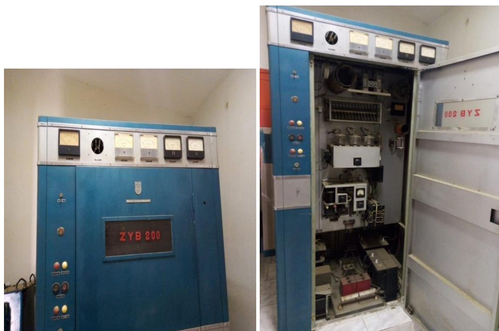
FIGURA 2 - Registros fotográficos do sistema de geradores utilizados na Rádio em seus primeiros anos de funcionamento, responsáveis por manter o funcionamento dos aparelhos de transmissão.
