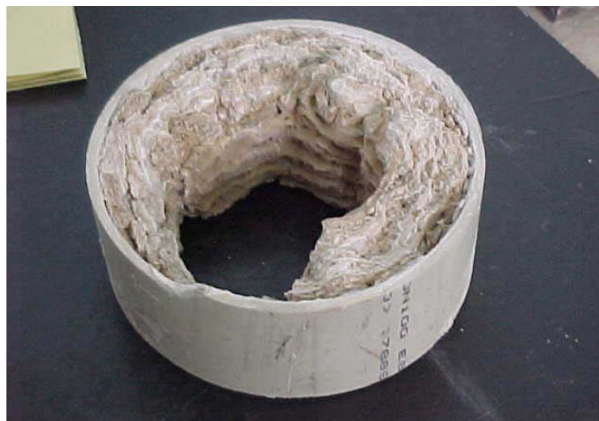
Figura 11 – Incrustação em tubulação de PVC causada pela presença de carbonato de cálcio na água.
