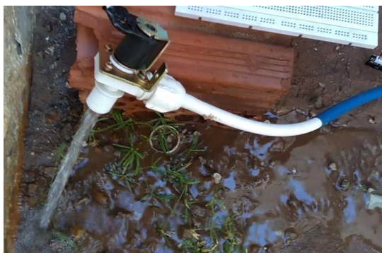
Figura 19: Teste com as válvulas solenóides com torneira.
