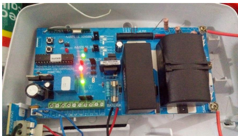
Figura 11: Placa da central de choque.
