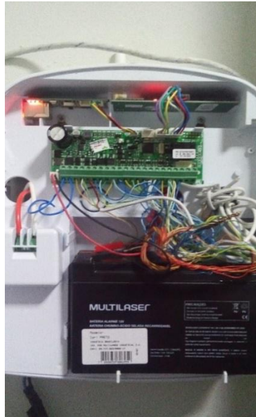
Figura 8: Central de alarme internamente.
