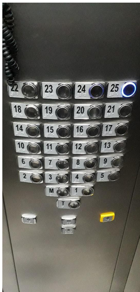
Figura 7: Painéis de chamada novos
