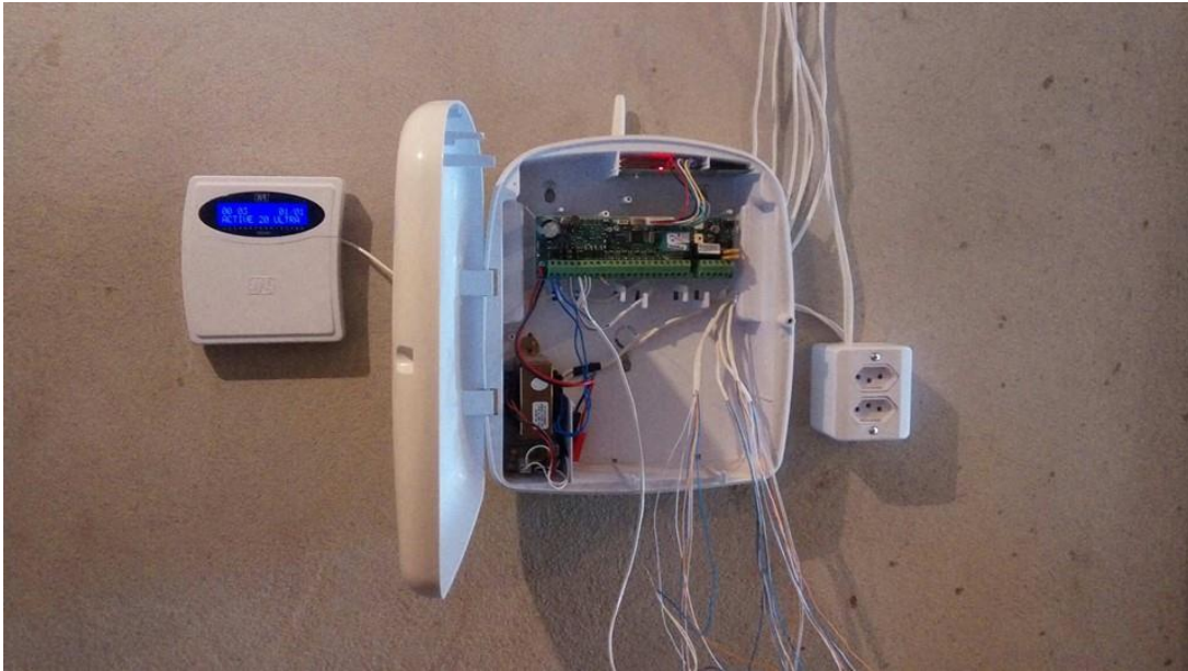
Figura 2 – central de alarme e teclado
