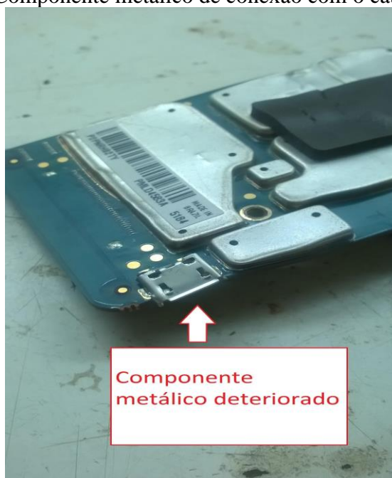
Figura 21 - Componente metálico de conexão com o cabo danificado.
