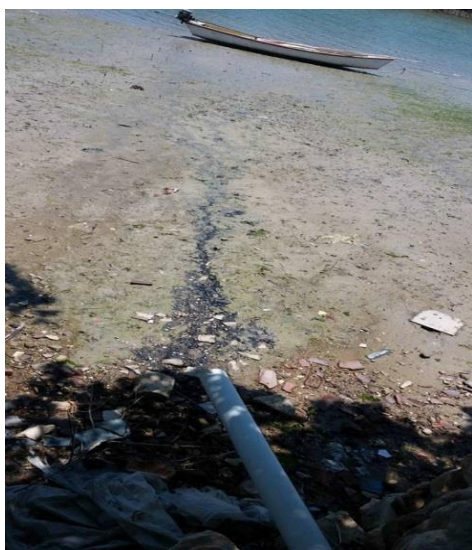
Figura 4- Esgoto desaguando no rio.
