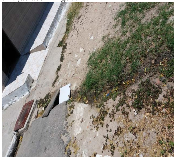
Figura 5- Fossa negra mal feita, escorrendo em direção aos mangues.
