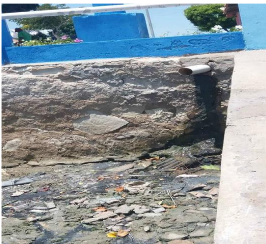
Figura 2- Lançamento de esgoto no rio
