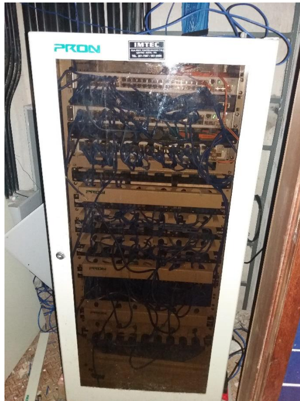
Figura 2 – Rack de rede localizado no Fórum Desemb. Miguel Seabra Fagundes
