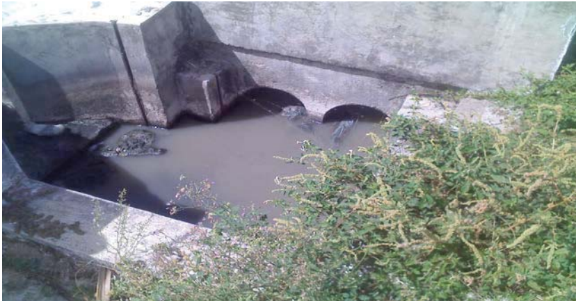
Figura 02- Estação de tratamento no Conjunto Amarante. Fonte: própria
