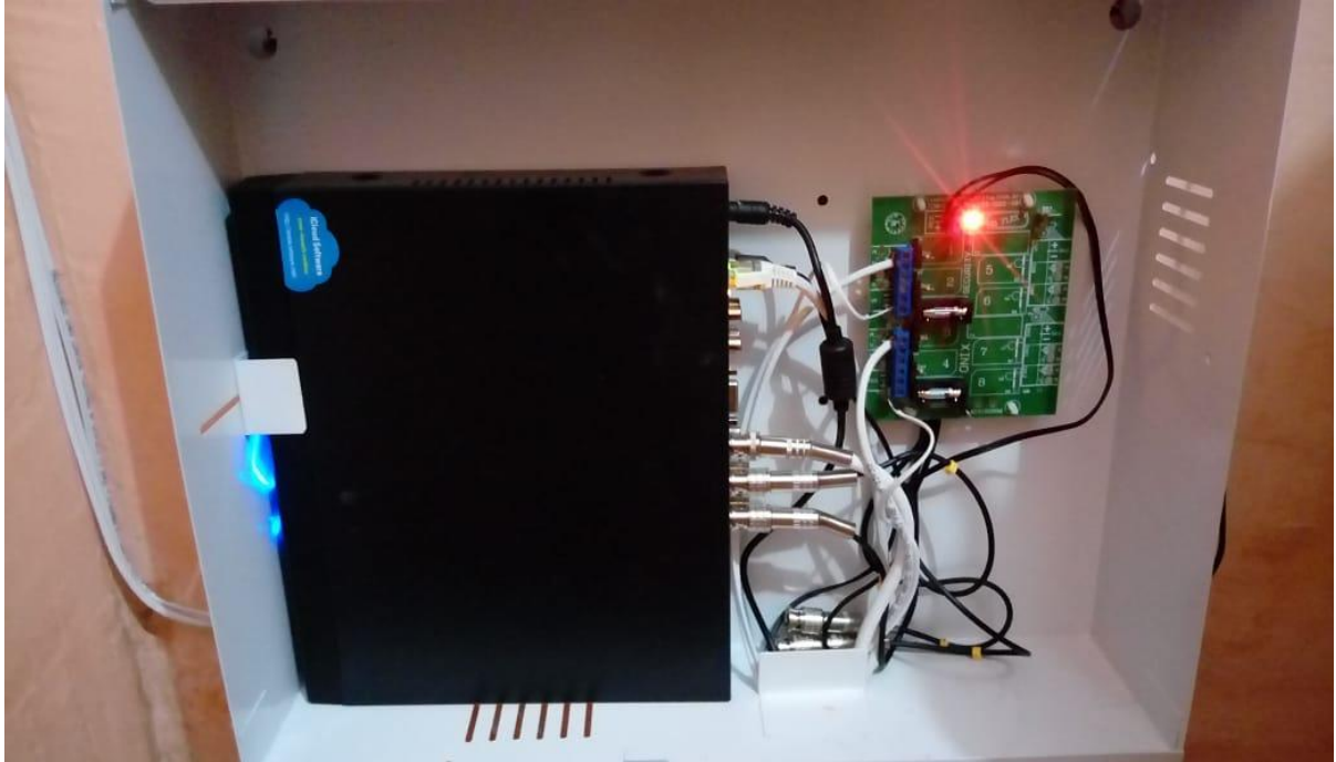
Figura 12: DVR Utilizado na Instalação de CFTV na Residência de Um Cliente
