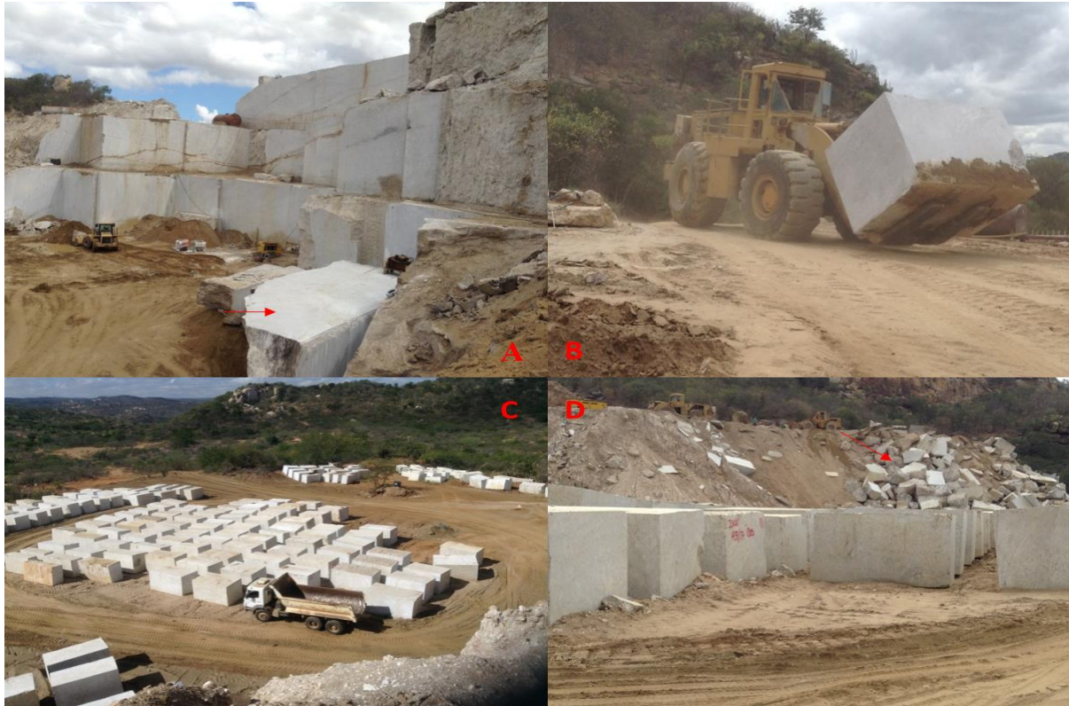
Fotografia 1 - Desmonte: A = Prancha tombada; B = Transporte do bloco para o pátio de estocagem; C = Pátio de estocagem, D = Deposição de rejeitos.
