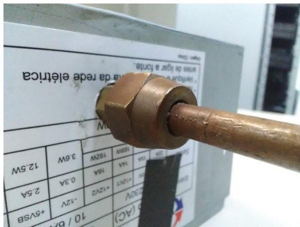
Figura 24 - Adaptação para instalação do tubo flexível de acoplamento à bomba de vácuo.
