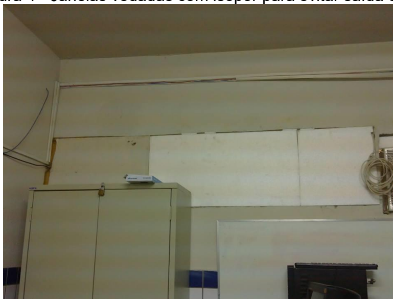
Figura 4 - Janelas vedadas com isopor para evitar saída de ar
