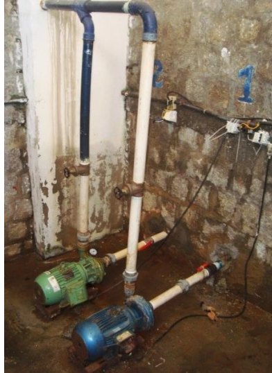
Figura 3 – Conjunto de bomba elevatória Fonte: Autoria própria (2017).
