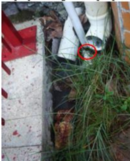
Figura 54 – Cano de esgoto quebrado Fonte: Autoria própria (2017).
