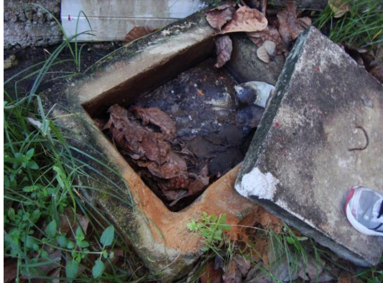
Figura 13 – Caixa de gordura Fonte: Autoria própria (2017).
