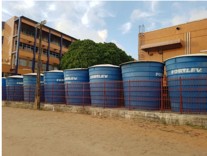
Figura 7 – Reservatórios para armazenamento de água pluvial Fonte: Autoria própria (2017).
