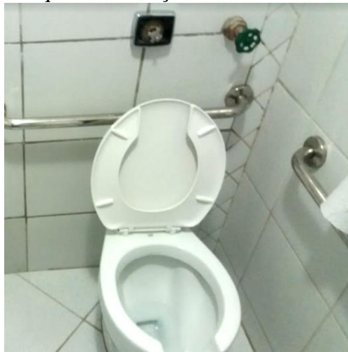
Figura 9 – Sanitário com válvula de descarga quebrada
