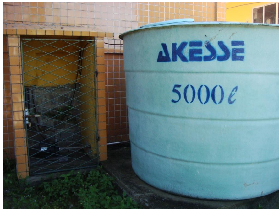
Figura 5 – Reservatório inferior instalado na DIAREN Fonte: Autoria própria (2017).
