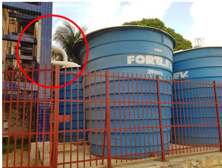
Figura 8 – Reservatórios com encanamentos Fonte: Autoria própria (2017).
