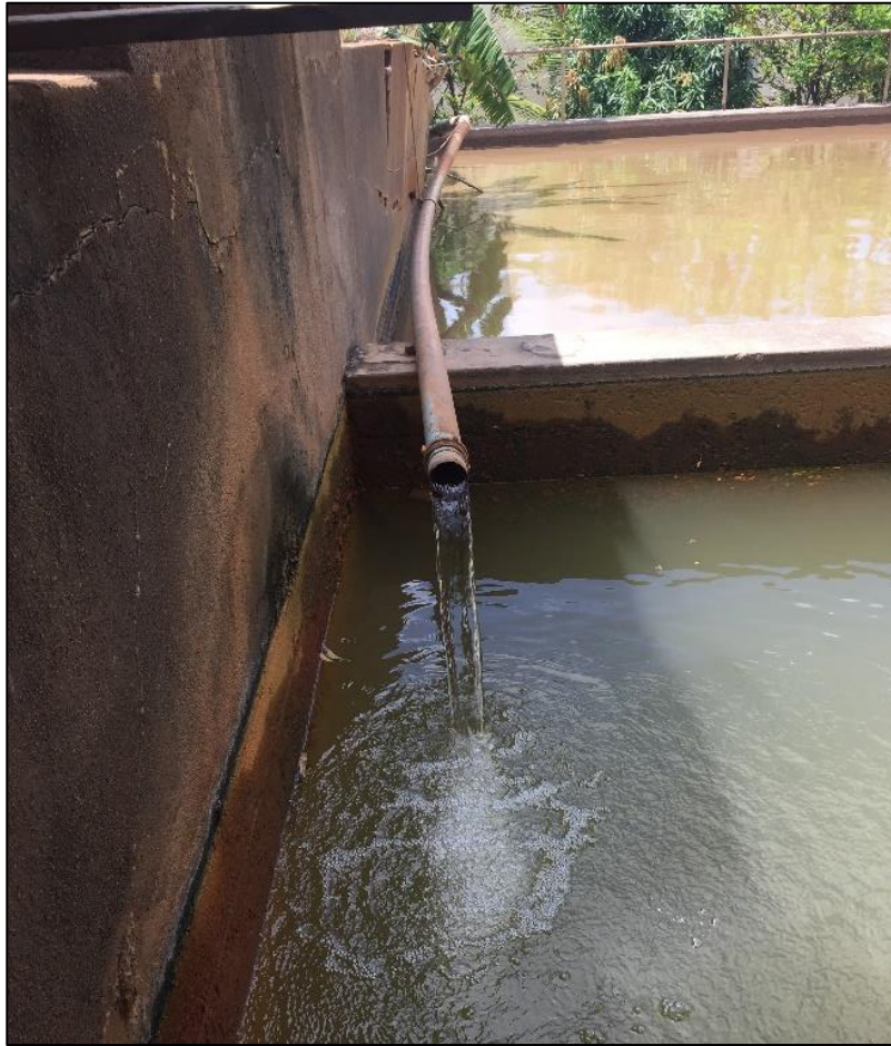
Fotografia 8 – Tanque de armazenamento de água da Mina Brejuí, com detalhe para tubulação de onde foi realizada a coleta da água.
