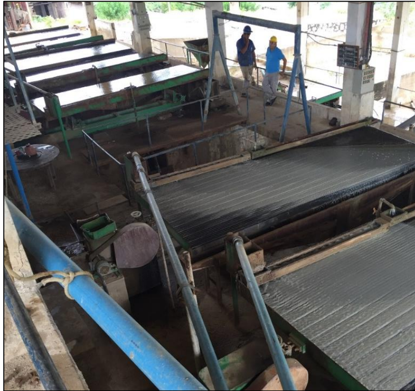
Fotografia 4 – Área de beneficiamento com detalhe para as mesas vibratórias (concentradoras) da Mina Brejuí.
