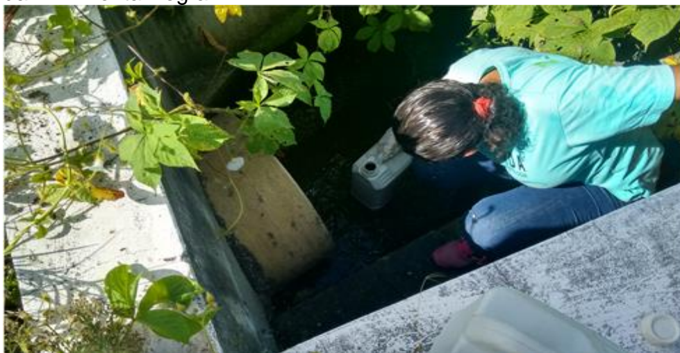
Figura 8 – Caixa de distribuição de vazão da segunda lagoa facultativa aerada da ETE Ponta Negra
