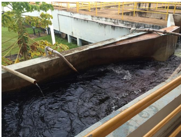
Figura 7 – Ponto de coleta de água bruta na ETA Extremoz – calha Parshall.
