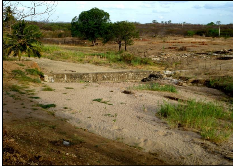
Figura 49 – Assoreamento de barragem no leito do rio Cobra, especificamente na comunidade Recanto em decorrência da retirada da mata ciliar
