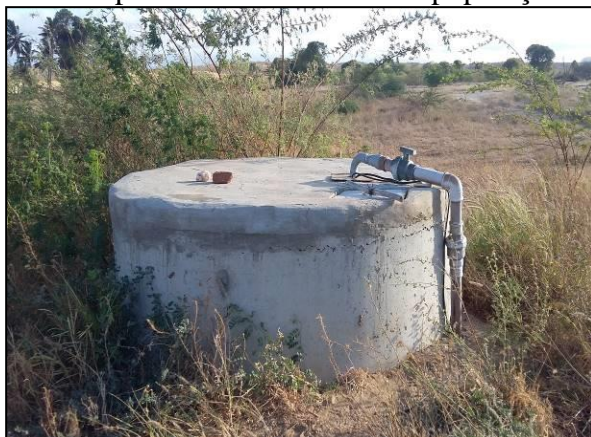
Figura 50 – Poço instalado na comunidade Recanto para o abastecimento da população
