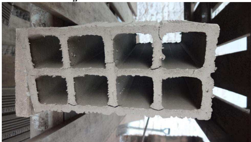
Figura 7. Bloco seco com trincas
