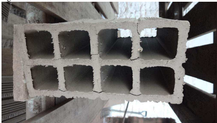
Figura 21 – Bloco seco com trincas.
